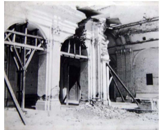
Fotografía 4.16: Esquina de Arquería Nor-Oriente con puntales y armazones de madera para detener la estructura. Fuente: Archivo MUSAC
