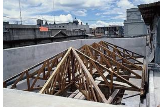
Fotografía 4.41 Cambio techo en el Área Administrativa. Fuente: Archivo Fotográfico Arq. Erwin Guerrero.
