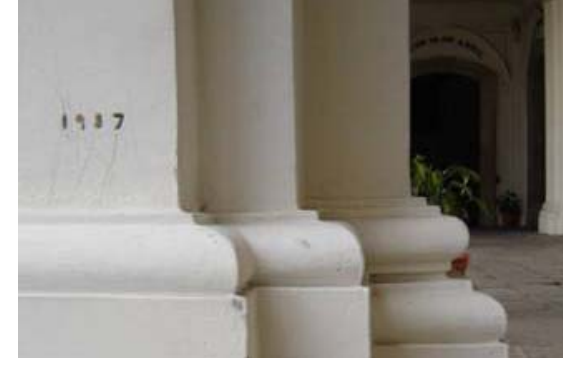
Fotografía 4.48 Se fecharon todas las columnas nuevas para tener un registro. Fuente: Archivo Fotográfico Arq. Erwin Guerrero.
