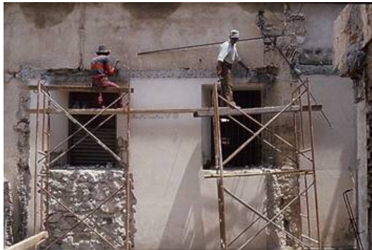
Fotografía 4.25: Cambios de Puertas a Ventanas. Fuente: Archivo Fotográfico Arq. Erwin Guerrero.
