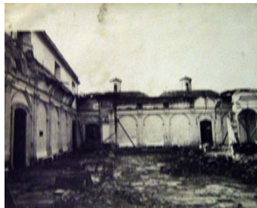
Fotografía 4.14: Vista del corredor sur-oriente totalmente destruido. Fuente: Archivo MUSAC.
