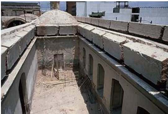
Fotografía 4.43 Salon 12 de abril cuando se le fue retirado el techo antiguo. Fuente: Archivo Fotográfico Arq. Erwin Guerrero.
