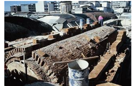
Fotografía 4.36 Se construyeron dos capas de mampostería en la bóveda de cañón. Fuente: Archivo Fotoaráfico Ara. Erwin
