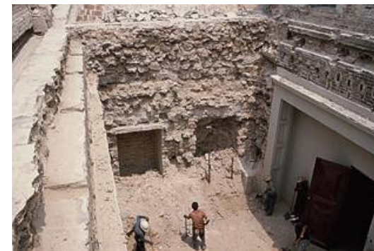
Fotografía 4.30: Integrando los Servicios Sanitarios al Vestíbulo del General Mavor. Fuente: Archivo Fotoaráfico Ara. Erwin Guerrero.
