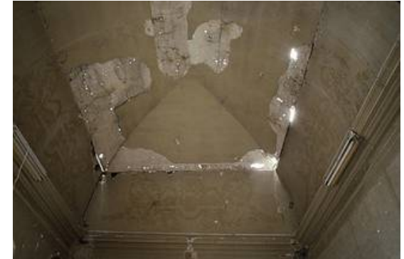
Fotografía 4.42 El techo del Salón 12 de Abril se tuvo que cambiar por su inestabilidad. Fuente: Archivo Fotográfico Arq. Erwin Guerrero.
