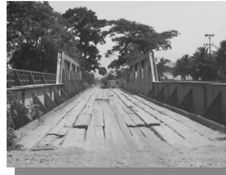
Fotografía No. 57. Puente Río Chinamito u Onondaga Fuente: Elaboración propia, visita de campo.
