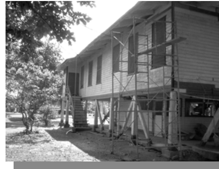
Foto No. 49. Una vivienda de madera en finca Primavera para personal administrativo, Distrito de Bobos. El propietario se encuentra en plena labor de mantenimiento porque desea habitarla nuevamente.
