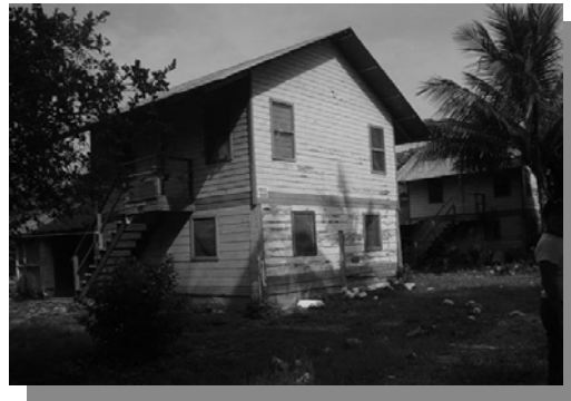
Foto No. 3. Vista de una casa de madera unifamiliar en Finca Primavera, antes llamada Finca Zaculeu, en el área rural municipio de Morales, Izabal, DISTRITO DE BOBOS. Fuente: Elaboración propia, visita de campo.
