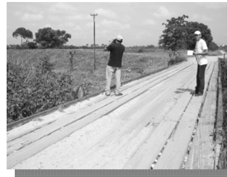
Foto No. 59. Puente Canal "I" en Finca Sebol Fuente: Elaboración propia. Visita de Campo
