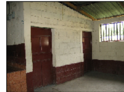
FOTOGRAFIA 3 En relación a las instalaciones sanitarias, como en otras evaluaciones, solo existe una bañeta por servicio, insuficiente para la cantidad de personas que se reúnen para cualquier evento.
