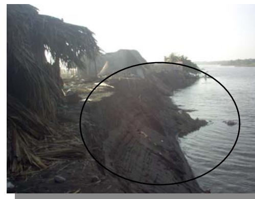
Imagen 01 Deslizamiento de Tierra (tormenta Stan)
