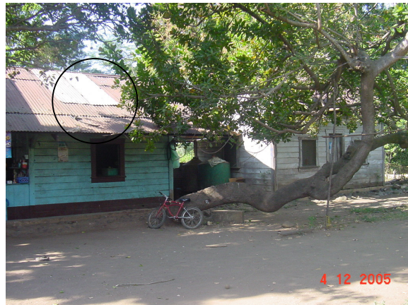
Fotografía 37 Decoloración de la pintura en todo el edificio, agregados en el Techo, polvo, manchas en muros.
