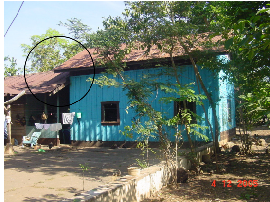
Fotografía 36 Presencia de oxidación en todo el techo, flora y humedad en toda la base del edificio.
