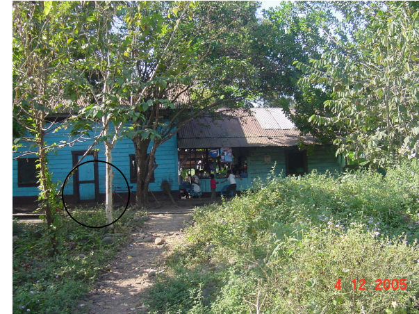
Fotografía 38 Algunas fracturas en dinteles de puertas y ventanas, hongos y flora, vegetación entorpecedora de la visual.
