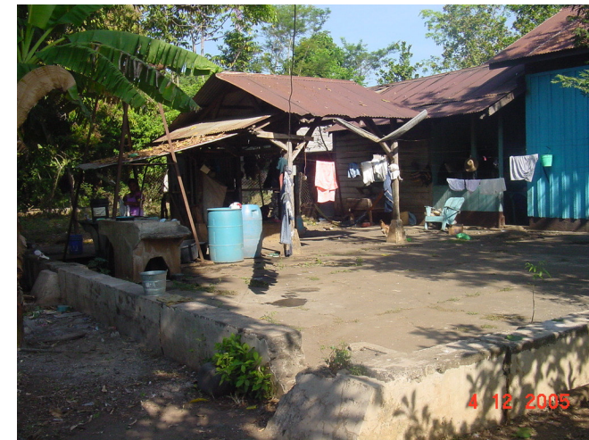
Fotografía 39 Fisuras y faltantes de marcos, agregados de párales para detener el techo. Decoloración total de la lámina zinc.
