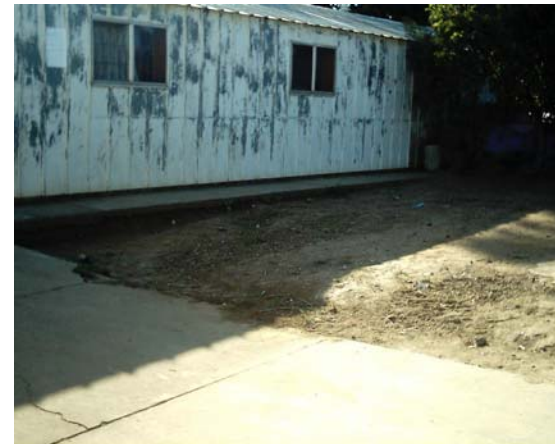
SE OBSERVA EL DETERIORO EN LAS INSTALACIONES DEL PUESTO DE SALUD
