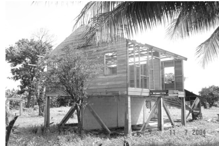
Foto No. 3- Vivienda destruidas por falta de mantenimiento - Distrito del Motagua.
