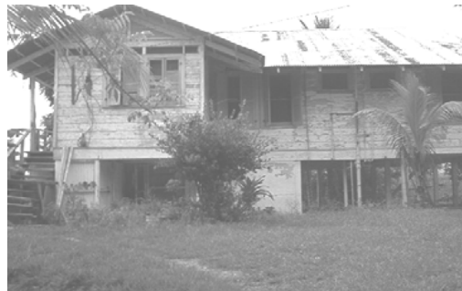
Foto No. 29 - Esta es alguna de las casa de la colonia del INDAPS, la cual como se puede apreciar se encuentran bastante deterioradas.
