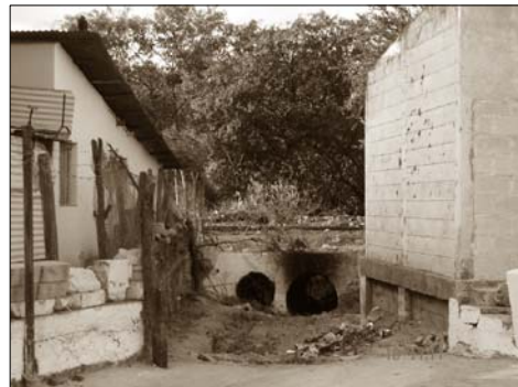
9 (Ilustración 60) SEGUNDO PUNTE, SUBTERRANEO, SIRVE DE AREA DE DESGUE Y ALCANTARRILLADO
