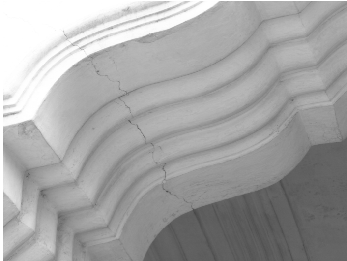
Gráfica 46: Fisuras por sismos en arcos mixtilíneos. Arcada Norte. En arco que atraviesa de codo a codo.
