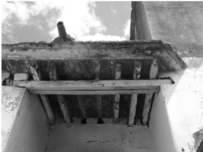
Gráfica 37: Deterioro de artesanado de terraza española, vestíbulo de servicio sanitario. Se muestra la disgregación de materiales a causa de humead.
