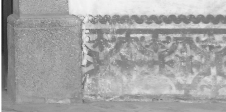
Gráfica 33: El zócalo se encuentra en las paredes exteriores hacia patio central.
