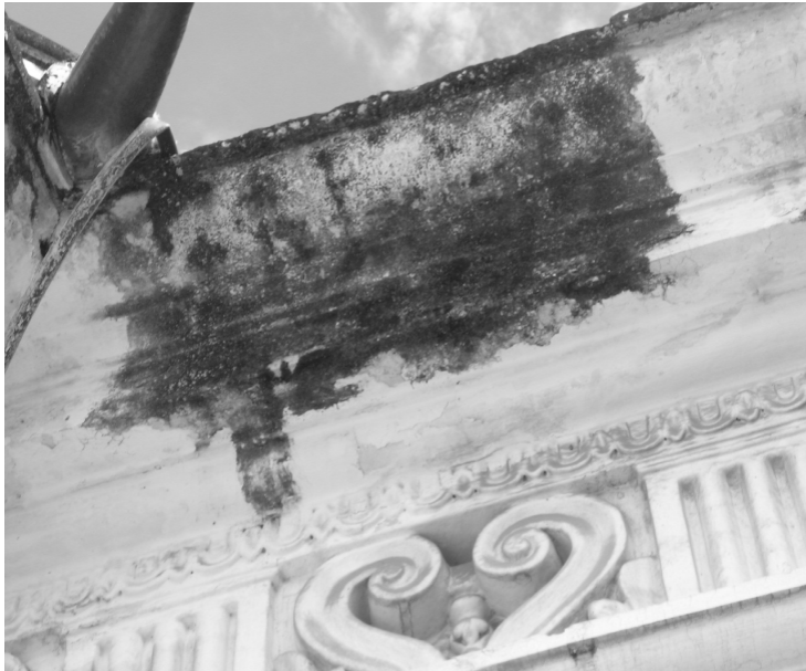
Gráfica 40: hongos a causa de humedad bajo gárgola. Esquina nor. -oeste
