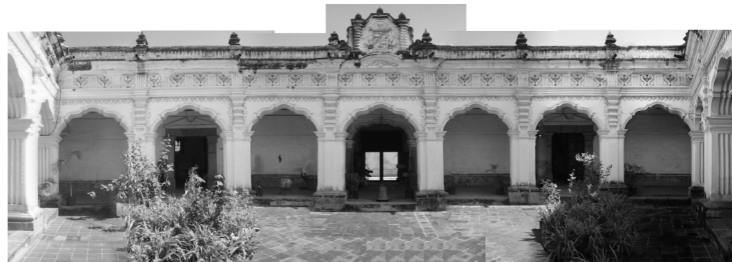
GRÁFICA 9: FACHADA FRONTAL INTERNA, se muestran los hongos sobre ésta.
