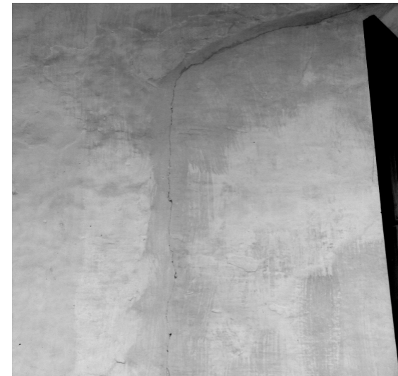
Gráfica 47: Puerta tapiada por remodelación de 1842, en sacristía. Lado oeste. Se observa la grieta formada en la orilla del vano tapiado.
