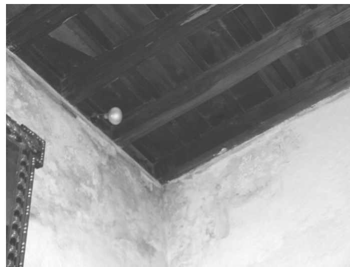
Gráfica 45: Deterioro de techo a causa de humedad. Interior sala No.1
