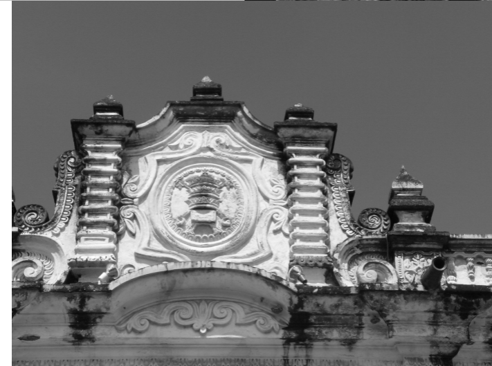
Gráfica 41: Manchas de humedad en remates de fachadas de corredores. Remate este.
