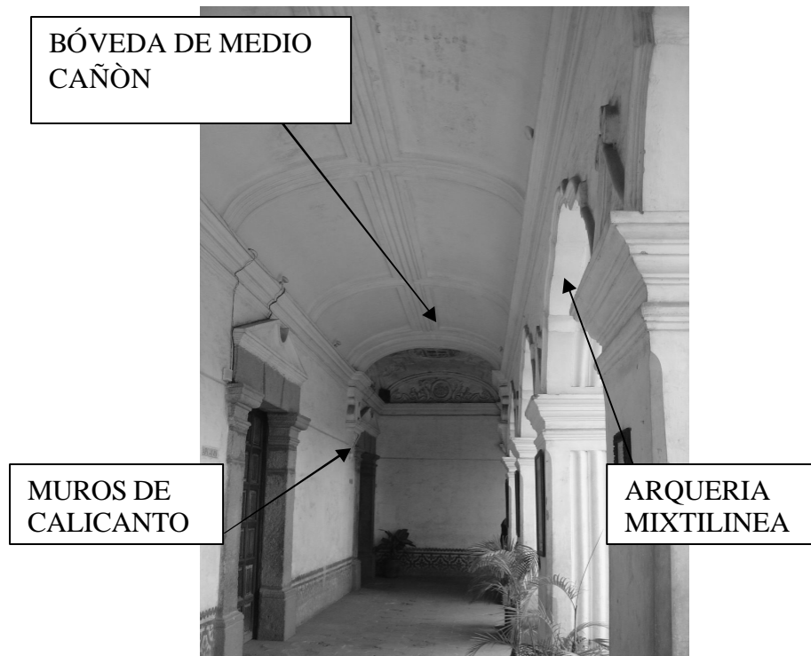
Gráfica 27: Corredor sur. Antigua Universidad de San Carlos. Se observa la bóveda vahída
