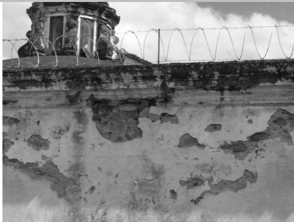
Gráfica 43: Desprendimiento de acabado por falta de mantenimiento y filtración de humedad. Pared exterior colindancia con Colegio de Indios.
