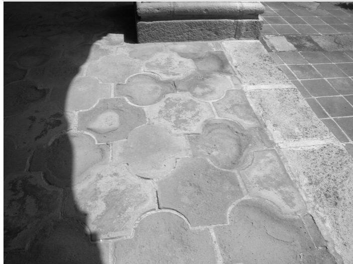
Gráfica 38: Deterioro en pisos. Por falta de mantenimiento. Corredor este.
