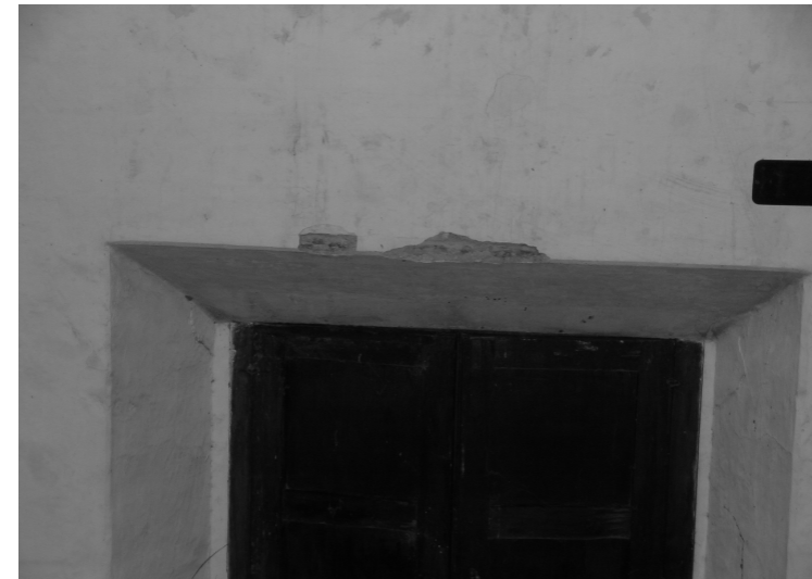
Gráfica 42: Desprendimiento de acabado en puerta, por falta de mantenimiento. Actual biblioteca.
