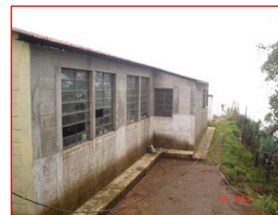
FOTOGRAFÍA 3 Muro posterior, con muestras de humedad, vidrios rotos en las ventanas. Instalación de Agua vista.
