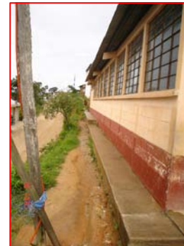
FOTOGRAFIA 1 Vista de parte posterior del módulo de aulas, el cual se encuentra a la orilla de un corte de terreno sin tratamiento.
