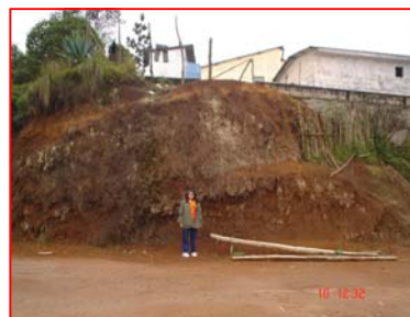
FOTOGRAFÍA 3 Talud de más de 3.00 mts. de alto, sin tratamiento en solar donde se ubica la escuela.
