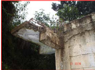
FOTOGRAFIA 1 Estructura de columna y vigas espuesta, con alto grado de oxidación.
