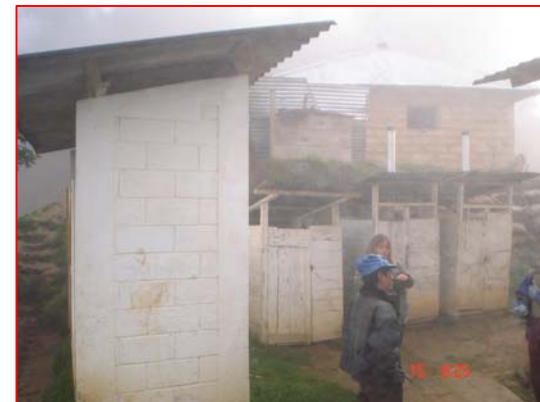
FOTOGRAFIA 2 Letrinas en mal estado.
