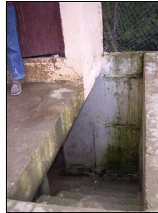
FOTOGRAFIA 1 Humedad y detritorio en módulo de letrinas.
