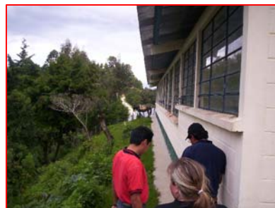
FOTOGRAFIA 5 Muro de módulo de aulas, inmediato a deslizamiento de grandes proporciones ocasionada durante la Tormenta Stan, en el 2005.
