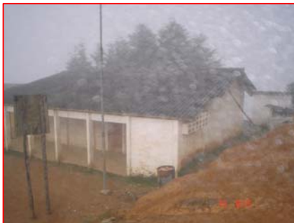
FOTOGRAFIA 4 Módulo de Aulas, en terreno con corte sin tratamiento.
