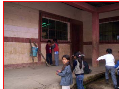
FOTOGRAFIA 2 Estudiantes durante su tiempo de recreo, se observa grieta en la losa del piso.
