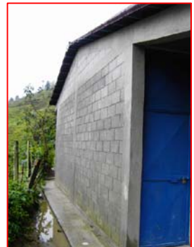
FOTOGRAFIA 4 Vista lateral de Módulo de Aulas, se observa humedad en la base de los muros.
