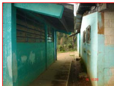
FOTOGRAFIA 4 Psillo interior de la Escuela, en donde se observa humedad.
