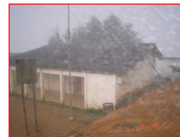
FOTOGRAFÍA 1 Módulo de Aulas contiguo a Cancha Deportiva y a corte del terreno sin tratamiento.
