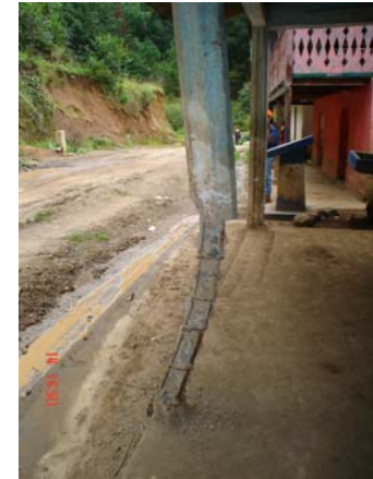
Fotografía No. 2.1 Detalle de Columna de Escuela en desuso en Aldea El Rosario, Tacaná
