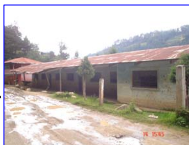
FOTOGRAFÍA 4 Escuela en desuso a causa de su destrucción por deslizamiento durante la Tormenta Stan en el 2005.
