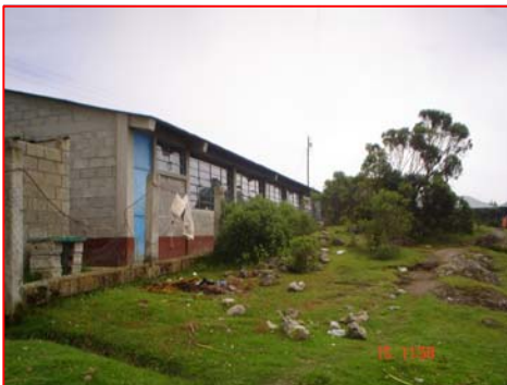
FOTOGRAFIA 4 Circulación de malla en mal estado, lo cual representa un riesgo para los usuarios.
