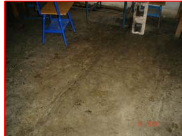
FOTOGRAFIA 2 Piso de cemento fundido, con grietas estructurales.
