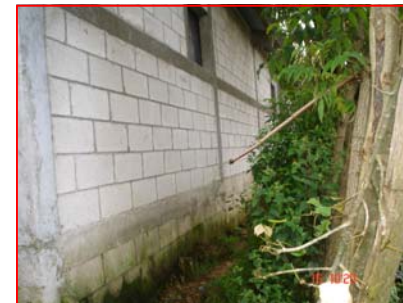
FOTOGRAFIA 3 Muro de Módulo de Aulas, en mal estado, se observa humedad.
