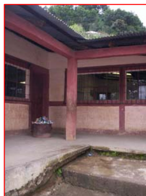
FOTOGRAFIA 2 Vista de módulo de Aulas, se observa la losa con rajaduras y humedad.
