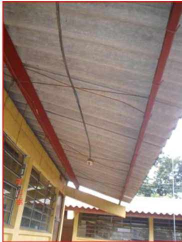
FOTOGRAFIA 1 Instalación eléctrica expuesta.
