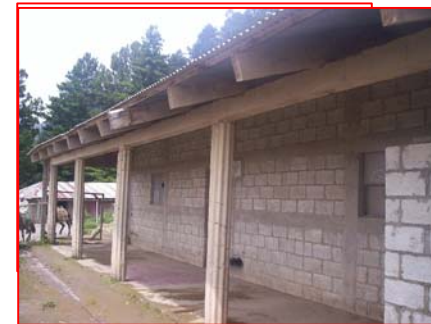
FOTOGRAFIA 3 Módulo de aulas de block visto, cubierta de madera y lámina en mal estado.
