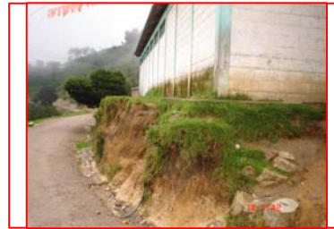
FOTOGRAFÍA 1 Calle de terracería en buen estado, aledaña a la Escuela, se observa ausencia de aceras o caminamientos, lo cual constituye un riesgo para los peatones. Talud sin tratamiento.
