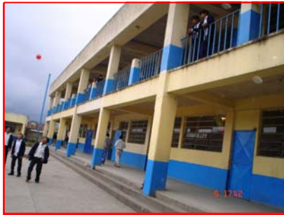
FOTOGRAFIA 1 Barranda de metal en buen estado, se observa estructura del edificio en buen estado, así como los caminamientos, puertas y gradas.
