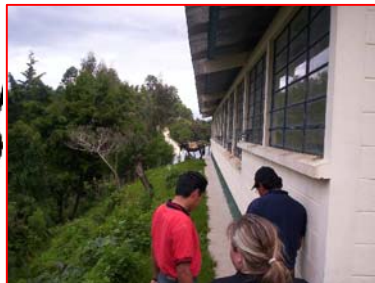
FOTOGRAFÍA 1 Talud aledaño a Escuela, donde ocurrió un deslizamiento para la Tormenta Stan el 2005.
