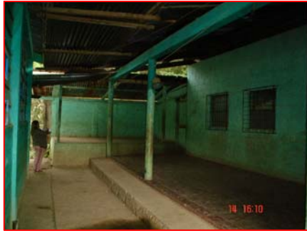
FOTOGRAFIA 1 Se observan instalaciones eléctricas expuestas, láminas en mal estado y deterioro en la pintura de los muros.
