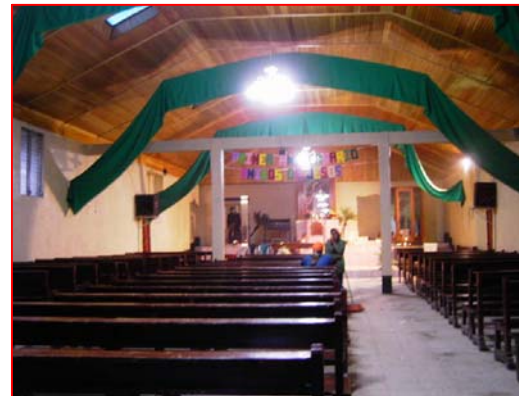
FOTOGRAFIA 2 Interior de Iglesia, se observa marco de columnas y viga que no corresponde a la estructura de la edificación.
