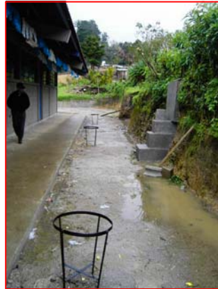
FOTOGRAFIA 2 Se sugiere realizar trabajos de mitigación en el corte del terreno adyacente a la escuela.
