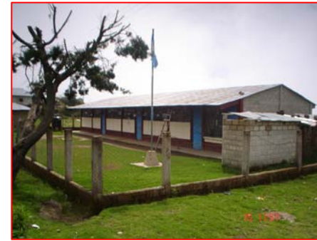
FOTOGRAFIA 3 Vista de la escuela, la cual posee circulación de malla, la cual necesita mantenimiento.
