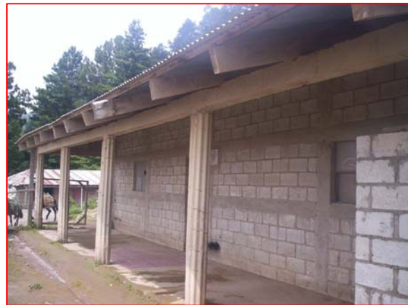
FOTOGRAFIA 2 Muros de block visto, se recomienda impermeabilizarlos con pintura o repello, la madera de la estructura portante del techo está en mal estado, al igual que las láminas de la cubierta.
