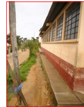
FOTOGRAFIA 6 Vista lateral de Módulo de Aulas, se observa corte del terreno sin tratamiento.
