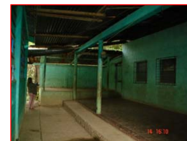
FOTOGRAFIA 6 Vista interior de la Escuela, se observa, humedad y deterioro en acabados de la edificación.
