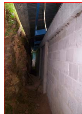
FOTOGRAFIA 3 Corte del terreno, aledaño a Iglesia, necesita tratamiento con muro de contención, para mitigar riesgo de deslizamiento.
