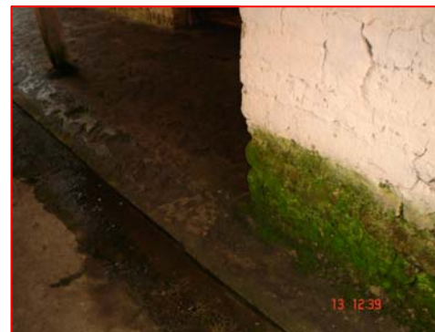
FOTOGRAFIA 3 Humedad y filtración de agua proveniente del suelo.
