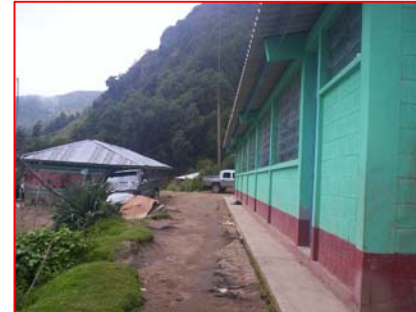
FOTOGRAFIA 2 Necesita tratamiento en áreas verde, caminamientos y muros de contención.
