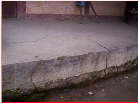
FOTOGRAFIA 1 Grietas en fundición de piso.
