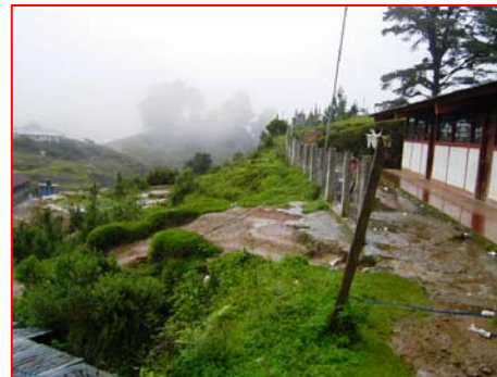
FOTOGRAFÍA 1 Terreno en donde se ubica la escuela, se observan cortes al terreno sin tratamiento, circulación en mal estado.
