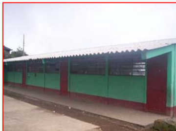
FOTOGRAFIA 1 Vista frontal del Módulo de Aulas, se observan vidrios quebrados.
