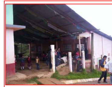
FOTOGRAFÍA 1 Ingreso principal a Escuela. Se observa el piso de tierra del espacio entre los módulos.
