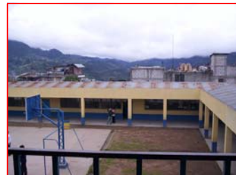
FOTOGRAFIA 5 Se observa la cubierta de lámina de zinc oxidada en algunas partes. Necesidad de tratamiento y mantenimiento en áreas verdes. Caminamientos en buen estado. Cancha deportiva en buen estado.
