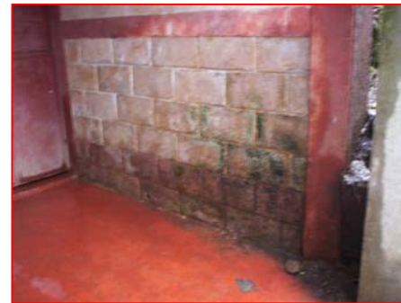
FOTOGRAFIA 4 Humedad en muros.
