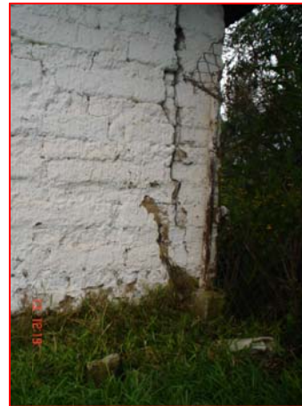
FOTOGRAFIA 1 Grieta estructural en muro de adobe.
