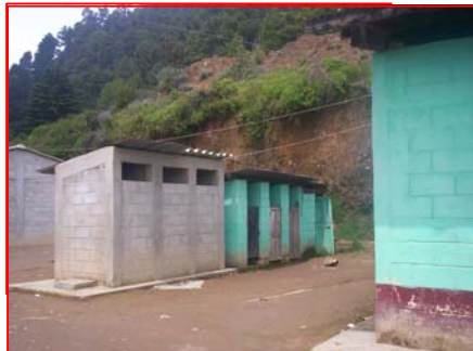
FOTOGRAFIA 1 Letrinas en mal estado
