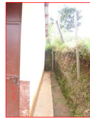
FOTOGRAFIA 6 Muro lateral de Módulo de Aulas, corte del terreno sin tratamiento.
