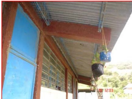
FOTOGRAFIA 1 Se observa estructura de cubierta en buen estado, se debe reponer los vidrios rotos de las ventanas.
