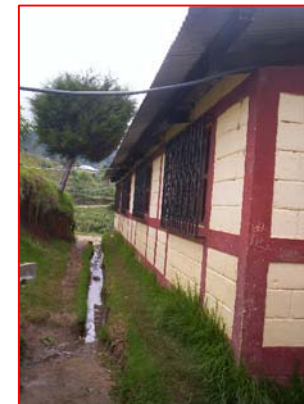
FOTOGRAFIA 5 Drenaje visto de agua pluvial, aledaño a Edificio Escolar.
