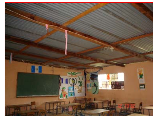
FOTOGRAFIA 2 Interior de Aula, se observa instalación eléctrica expuesta, así como humedad en estructura portante de cubierta.
