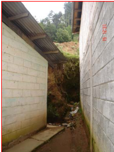
FOTOGRAFIA 1 Muros con humedad en la base, corte de terreno sin tratamiento, mal manejo de la basura.
