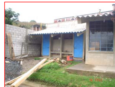
FOTOGRAFÍA 1 Letrinas recién construidas, en buen estado.
