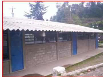
FOTOGRAFIA 2 Módulo de aulas, de block visto, láminas en mal estado.
