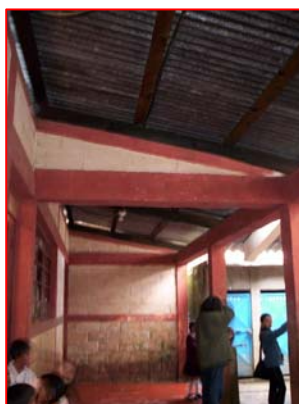
FOTOGRAFIA 4 Vista de cubierta de láminas, las cuales se encuentran deterioradas y con goteras.
