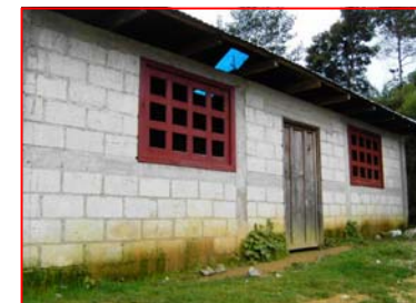
FOTOGRAFIA 6 Salón de clases de block visto, el cual presenta humedad en la base de los muros, puerta de madera deteriorada y láminas de cubierta en mal estado.
