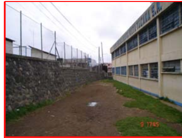
FOTOGRAFIA 2 Talud con tratamiento en piedra y muro perimetral de malla en buen estado, ventanería necesita reemplazo de algunos vidrios rotos y limpieza, falta de tratamiento y mantenimiento en áreas verdes.
