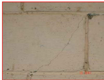
FOTOGRAFIA 2 Grieta estructural en muro de block.
