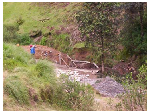
FOTOGRAFIA 3 Construcción de Cancha Deportiva en el cauce de vertiente del Rio Coatán
