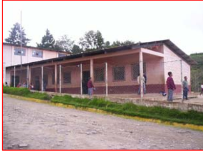
FOTOGRAFIA 1 Frente de Módulo de Aula aledaño a cancha Deportiva, circulación de malla en mal estado.
