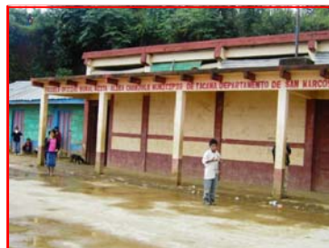
FOTOGRAFIA 4 Salón de clases. Se observa mal estado de láminas en la cubierta.
