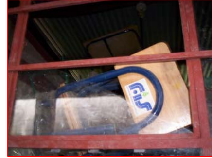
FOTOGRAFIA 3 Vidrios rotos y mobiliario subutilizado.
