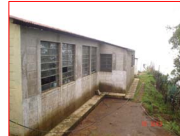
FOTOGRAFIA 3 Vista posterior de la escuela donde se observa humedad en base de muros y falta de algunos vidrios en las ventanas.
