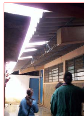
FOTOGRAFIA 5 Cubierta de láminas de asbesto, con láminas rotas.
