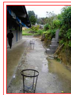
FOTOGRAFIA 3 Corte del terreno, con siembra de árboles, se sugiere mayor tratamiento, con un muro de contención.
