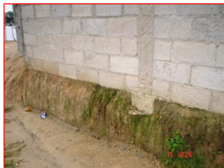
FOTOGRAFIA 4 Muro lateral de módulo de aulas de la escuela, con deterioro en cimiento, el cual se encuentra expuesto con signos de humedad.
