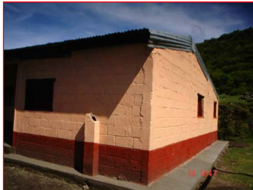
FOTOGRAFIA 1 Módulo de Aulas, columna colapsada, cubierta de lámina en mal estado.
