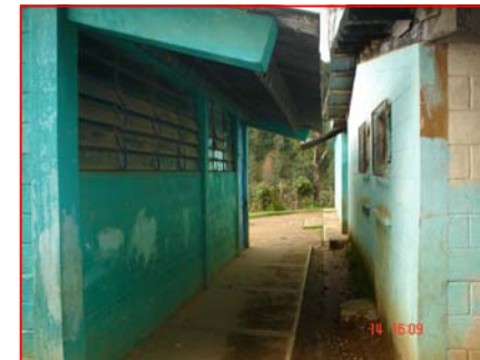
FOTOGRAFIA 3 Deterioro en estructura portante de techo, así como en las láminas de la cubierta.
