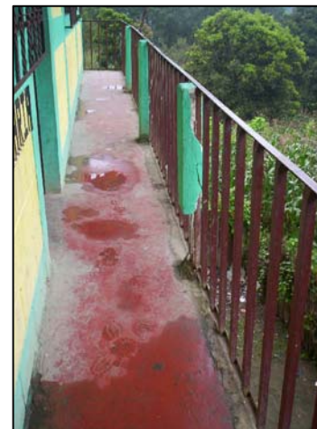
FOTOGRAFIA 2 Baranda de corredor en mal estado.
