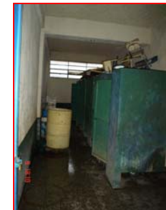
FOTOGRAFIA 7 Se observa el deterioro en que se encuentran las baterías de servicios sanitarios, humedad, problema de abastecimiento de agua entubada, falta el bombillo de luz, se recomienda no almacenar mobiliario en mal estado en este lugar.
