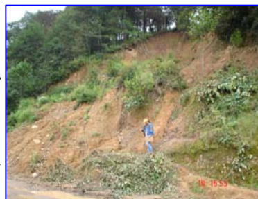
FOTOGRAFÍA 1 Deslizamiento ocurrido durante la Tormenta Stan en el 2005, el cual destruyó completamente la escuela adyacente a la carretera.
