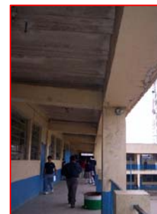
FOTOGRAFIA 6 Se observa humedad en la cubierta de lámina de asbesto. Desprendimiento en repello y pintura, debido a la humedad. Necesidad de mantenimiento, limpieza y pintura.
