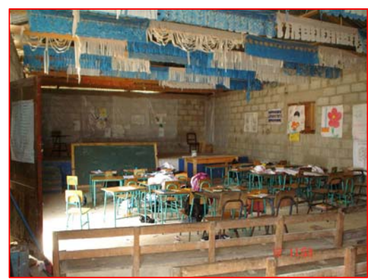
FOTOGRAFIA 4 Vista interna de Aula, se observa el abatimiento de las puertas hacia adentro, lo cual debe de ser hacia afuera para casos de evacuación de emergencia.
