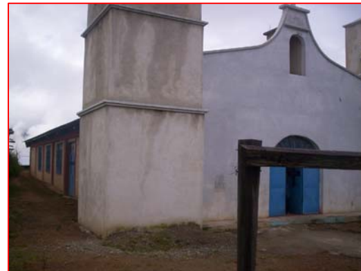
FOTOGRAFIA 2 Vista del edificio, se recomienda impermeabilizar los muros, así como la fachada principal, para evitar humedad.
