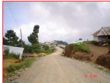
FOTOGRAFÍA 1 Calle de terracería en buen estado, que comunica al poblado con el resto del Municipio, se observa ausencia de aceras o caminamientos. lo cual constituye un riesgo para los peatones.
