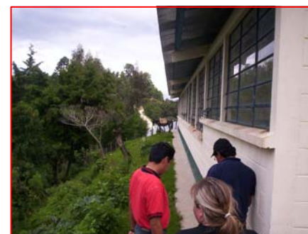
FOTOGRAFÍA 3 Parte posterior de Módulo de Aulas en riesgo.
