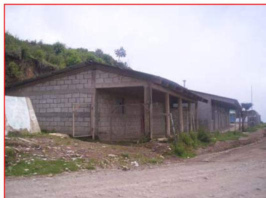
FOTOGRAFIA 4 Vista de dos módulos de aulas, se observa corte de terreno sin tratamiento en la parte posterior.
