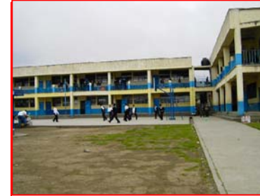
FOTOGRAFIA 3 Patio central del edificio en donde se encuentra la cancha deportiva, se observa falta de mantenimiento y tratamiento en áreas verdes, así como en la pintura del edificio. Caminamientos en buen estado. Estructura del edificio en buen estado.
