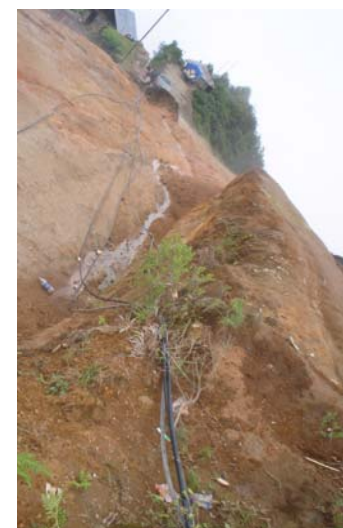
Fotografía No.4. 7 Conducción de agua entubada en Caserío Agua Zarca, Tacaná
