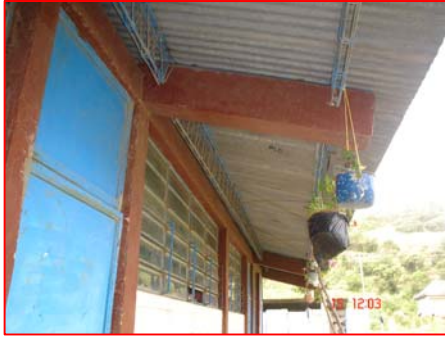
FOTOGRAFIA 1 Estructura portante de cubierta, la cual necesita mantenimiento. Ventanería deteriorada, necesita reposición de algunos vidrios.
