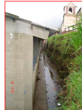
FOTOGRAFIA 1 Corte del terreno aledaño a Módulos de Aulas, se observa lámina de cubierta de techo en mal estado.
