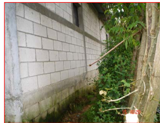
FOTOGRAFIA 2 Muro lateral de módulo de aulas, en mal estado, se observa humedad en la cimentación y en los muros.
