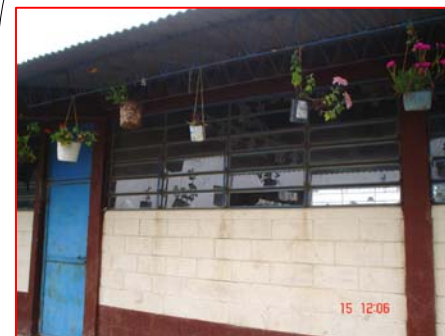
FOTOGRAFIA 3 Se observa buen estado en los muros y puertas, se deben reponer vidrios de las ventanas.
