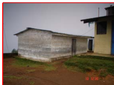
FOTOGRAFIA 4 Aula de madera, en mal estado.
