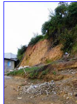
FOTOGRAFÍA 1 Se observan cortes del terreno, sin tratamiento, en los cuales se observan humedad y erosión. Mal manejo de la basura.
