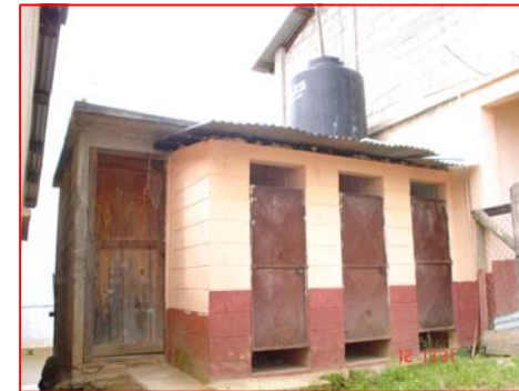
FOTOGRAFIA 1 Cubierta de letrinas en mal estado.
