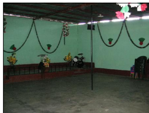
FOTOGRAFIA 1 En dicha fotografía, muestra la insuficiente ventilación e iluminación que existe, esto debido a que solo cuenta con tres ventanas en todo el edificio. El material de cubierta no es el adecuado tanto para el lugar como para las personas que utilizan dicho establecimiento.
