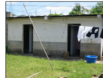
FOTOGRAFIA 4 Los servicios sanitarios son insuficientes, no cuenta con privacidad ya que carecen de puertas, el funcionamiento es irregular.
