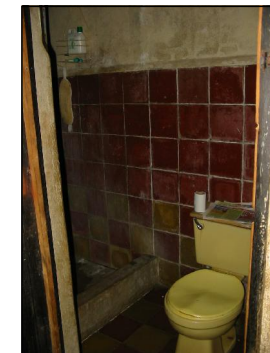
FOTOGRAFIA 3, 4 y 5 El área de los servicios sanitarios, son insuficientes para la cantidad de usuarios del edificio. Estos no tienen ningún mantenimiento preventivo y por consiguiente el 50% se encuentra en mal estado.
