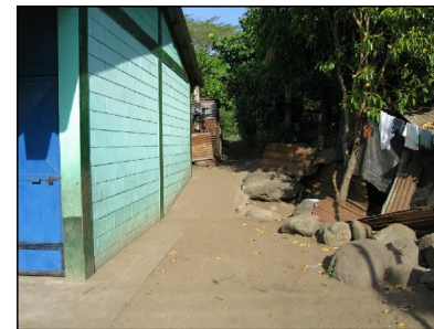
FOTOGRAFIA 2 La fotografía muestra la falta de protección del edificio, pues no cuenta con muro perimetral o de otro tipo.
