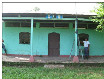
FOTOGRAFIA 3 Nos muestra la fotografía que la iluminación es insuficiente, debido al tamaño de las ventanas.
