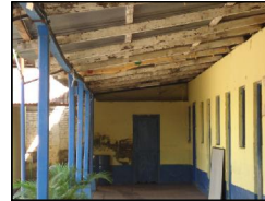
FOTOGRAFIA 1 Como lo muestra en la fotografía, el tamaño de la ventanería, no es el adecuado para brindar una iluminación mínima a los distintos ambientes, siendo también la ventilación inadecuada, esto hace que el interior de dichos ambientes no sea de confort.
