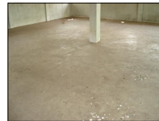
FOTOGRAFIA 6 El piso del edificio es torca de cemento la cual se encuentra en buen estado.
