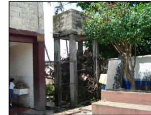
FOTOGRAFIA 5 El edificio cuenta con tanque elevado, el mantenimiento de este ha sido poco, debido a que no hay un presupuesto para ello, así como la ampliación de los servicios sanitarios no ha sido factible.
