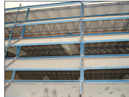
FOTOGRAFIA 2 El cerramiento de los ambientes, específicamente la ventanería, se encuentra en buen estado, se observa que las instalaciones eléctricas están expuestas.
