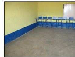
FOTOGRAFIA 8 En esta fotografía se observa la poca iluminación y ventilación de los ambientes.
