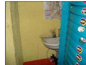
FOTOGRAFIA 6 La altura del edificio como se observa en la fotografía, es escasa, se le une la estructura portante de lámina metálica con costaneras a 2 metros. Los servicios sanitarios son insuficientes para la cantidad de usuarios que utilizan el establecimiento.
