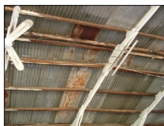
FOTOGRAFIA 3 Algunas láminas están dañadas por el peso del tiempo.
