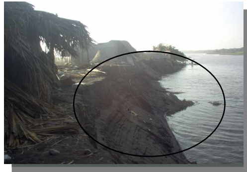
Imagen01 Deslizamiento Tierra (tormenta Stan)
