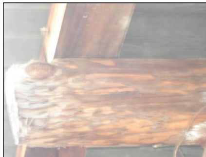
FOTOGRAFIA 2 Aca se muestra una viga dañada por la polilla, haciendo necesario reemplazar dicha viga, para mantener en buen estado la estructura portante de la cubierta.
