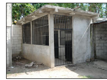
FOTOGRAFIA 1 Vista exterior de los servicios sanitarios siendo una construcción reciente, con problema de filtración en la losa, lo cual debe de repararse para evitar problemas posteriores en la estructura.
