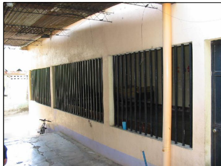
FOTOGRAFIA 2 La estructura portante de los ambientes es en forma de Jciet, en lo que se refiere a las ventanas, su cerramiento es en forma de barrotes para la seguridad correspondiente. Improvisación de instalaciones.
