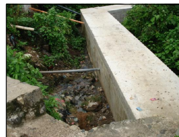
FOTOGRAFIA 6 El manejo de las tuberías de drenaje es adecuado pues están protegidos para evitar cualquier problema.
