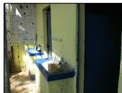
FOTOGRAFIA 7 Se observa el exterior de los servicios sanitarios, sin protección.
