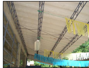
FOTOGRAFIA 1 Se observa la estructura portante y cubierta del edificio en buen estado.
