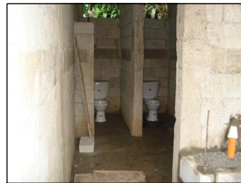
FOTOGRAFIA 5 Los servicios sanitarios, no cuentan con privacidad en sus ingresos.
