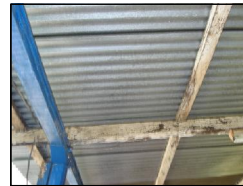
FOTOGRAFIA 2 Algunas de las piezas de la estructura del techo de madera, están deterioradas y necesitan ser reemplazadas.
