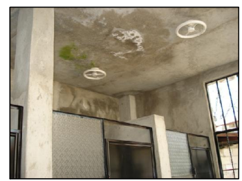
FOTOGRAFIA 3 Se observa la mancha de humedad en el cielo de los servicios sanitarios, debido a filtración de agua en la losa.
