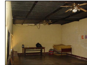
FOTOGRAFIA 1 Como lo muestra la fotografía, la altura de los ambientes es bastante reducida en un clima relativamente cálido. No tiene suficientes ventanas para una buena ventilación.
