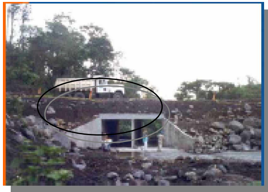
Imagen 05 Daños y/o destrucción de infraestructura vial y constructiva.
