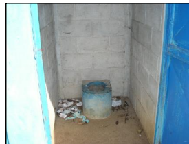
FOTOGRAFIA 4 Las letrinas utilizadas para el servicio de los usuarios del edificio necesitan mantenimiento.
