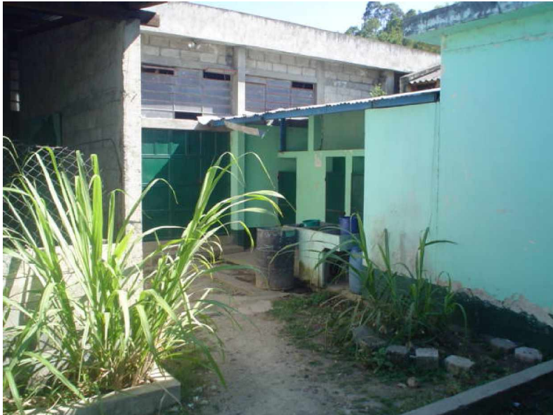
Foto No. 13 Baños en mal estado, por lo que lo empleados municipales, no cuentan con servicios de baños.
