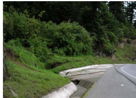
Desfogue de cuneta a caja rompe presión la cual cuenta con tubos que pasan por debajo de la carretera inclinados a 30° kilómetro 178, julio 2006.
