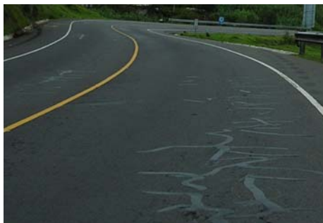
Kilómetro 179 se muestra la señalización horizontal y vertical al fondo, las líneas continuas se encuentran por tratarse de curva peligrosa, julio 2006
