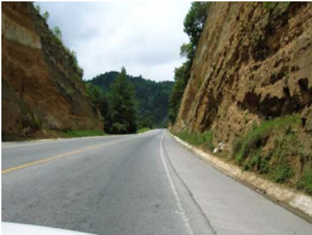
Corte de montañas para que la pendiente no sea tan fuerte, esto produce que los taludes sean muy grandes, kilómetro 178, agosto de 2006
