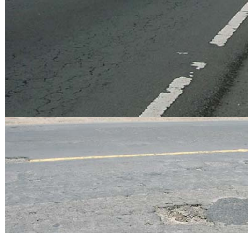
Muestra el deterioro que se esta produciendo en la carpeta asfáltica, la señalización horizontal cuenta con segmentos deteriorados. Los baches son de regular tamaño, pueden alcanzar 25 a 30 centímetros, el deterioro se percibe hasta la base de la carretera, esto se aprecia en diferentes puntos, julio 2006
