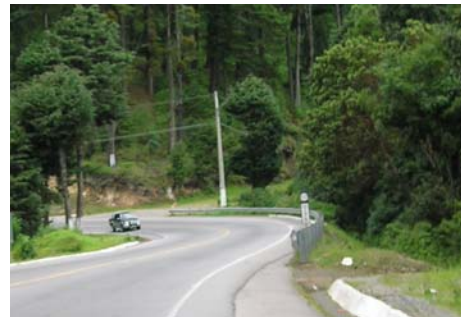
Barda protectora de curva en el kilómetro 175, julio 2006
