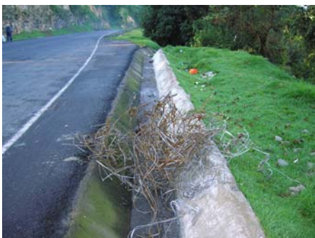
Cuneta de concreto armado obstruida con materiales que la población desecha desde la carretera, kilómetro 183, julio 2006.
