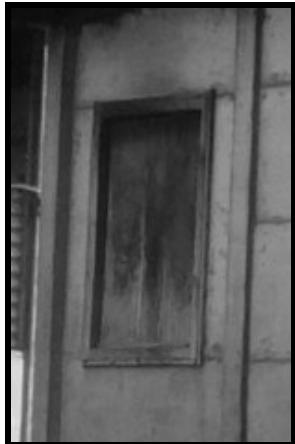
Fotografía No. 51: ventanas vivienda tipo 5
