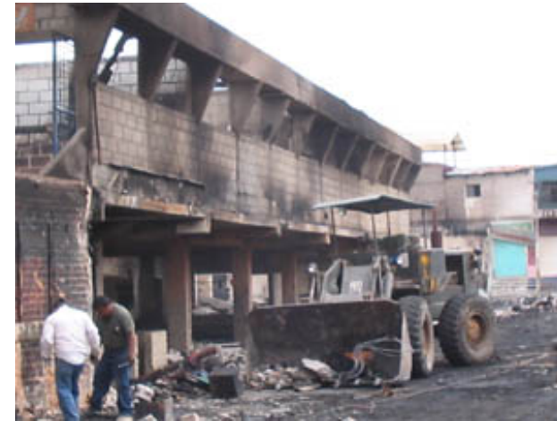
Ilustración 2: Trabajos de limpieza y vista de los daños que provocó el incendio.
