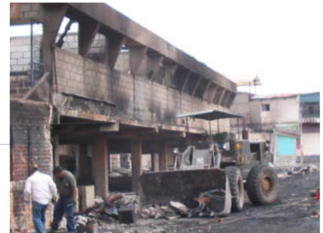
Fotografía 4: Este es el estado que dejó el incendio que devastó al mercado anterior, y la maquinaria esta haciendo los trabajos de demolición.
