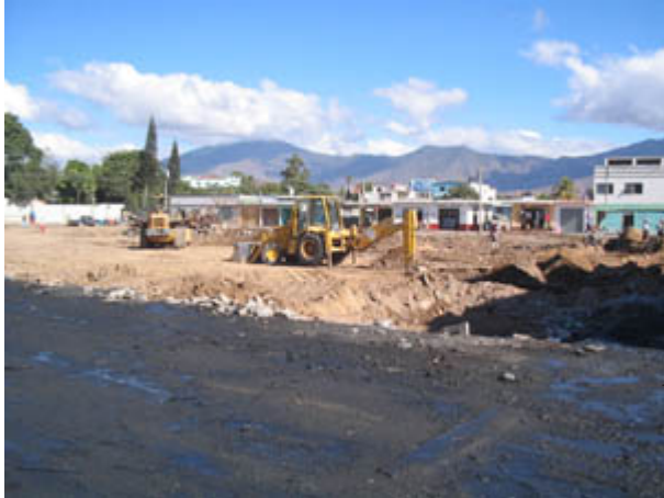
Fotografía 1: Esta es una panorámica del terreno municipal para el proyecto, y aquí se observa la maquinaria realizando los trabajos de nivelación y compactación del terreno, así como de las calles.
