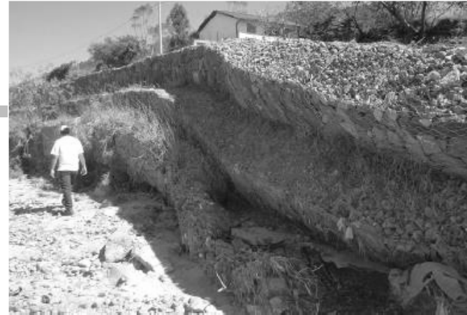
Gaviones del cauce del Río que se voltearon por socavación de su cimiento. Fuente: Vivamos Mejor
