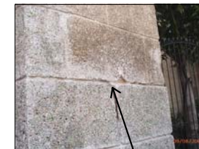
DESPRENDIMIENTO DE MATERIAL
