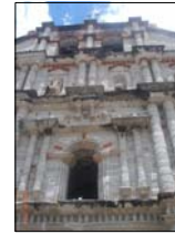
PRESENCIA DE HUMEDAD
