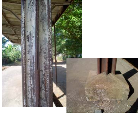
Imágenes 10 y 11. Estructura de andén en total deterioro. Fuente: Fegua.
