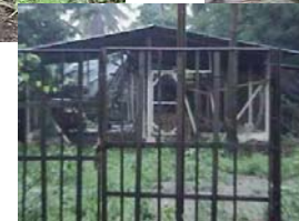
Imagen 33, 34 y 35. Destrucción de la vía férrea y bienes inmuebles. Fuente: Tomás realizadas por Marvín Pérez. Octubre 2003.
