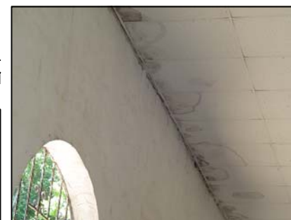
FOTOGRAFIA 3 En el cielo falso se puede observar las manchas de agua debido a la filtración que existe en la unión entre la lamina y la fachada, por lo que se debe de arreglar lo antes posible para evitar más deterioro del material.
