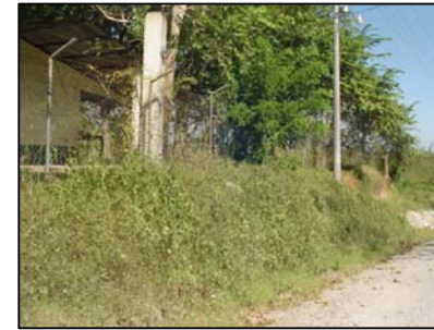
FOTOGRAFIA 5 en el frente de la escuela dá a la calle principal de tierra y por la pendiente se vá formando un talud que no tiene ningún tratamiento.
