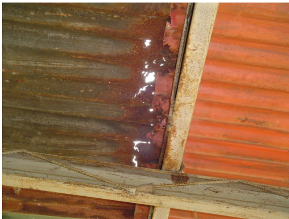
Fotografía No. 16: Techo deteriorado
