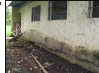
El aula en el modulo B, da evidencias de las inundaciones sufridas en el sector.
