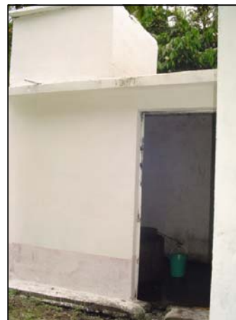
FOTOGRAFIA 5 Vista del cuarto de pozo de agua y su tanque elevado, recién llevado a cabo la obra.
