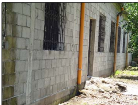
FOTOGRAFIA 4 Exterioresentas paredes laterales y trasera no cuenta con un tratamiento específico, lo que deja el material expuesto, notese las bajadas de agua pluvial expuestas las cuales descansan sobre el terreno del predio.
