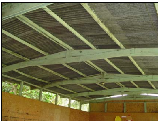
FOTOGRAFIA 4 La estructura de madera no ha tenido suficiencia mantenimiento por lo que es indispensable que se revise.
