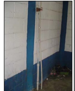
FOTOGRAFIA 6 Las instalaciones de agua potable son sobre puestas, posteriores a la obra inicial.
