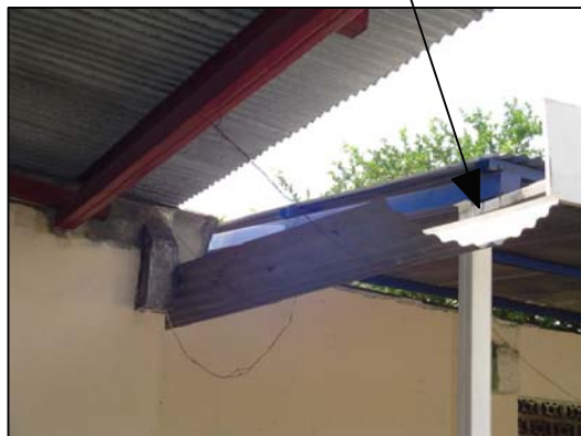
FOTOGRAFIA 4 en sus laterales de los pasillos no cuenta con canales, por lo que se improvisó con láminas de zinc.
