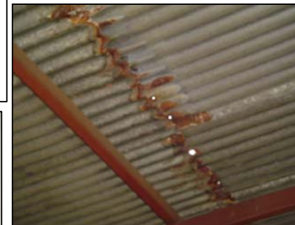
FOTOGRAFIA 3 Se puede ver el deterioro en las láminas de zinc, estan bastante oxidadas por lo que tienen goteras y con el problema que cuando estas caen, lo hacen con oxido. De igual forma están oxidadas las costaneras metálicas.
