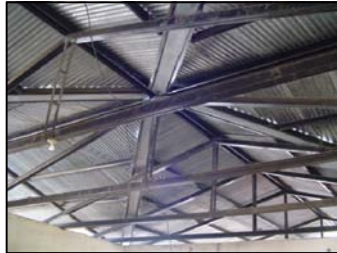
FOTOGRAFIA 4 en Masagua las instalaciones metálicas tienden a la corrosión, aunque en este momento se encuentran bien en estas escuelas es preferible que reciba su mantenimiento periódico para evitarlo ya que la construcción metálica en esta escuela es demasiada para las áreas.
