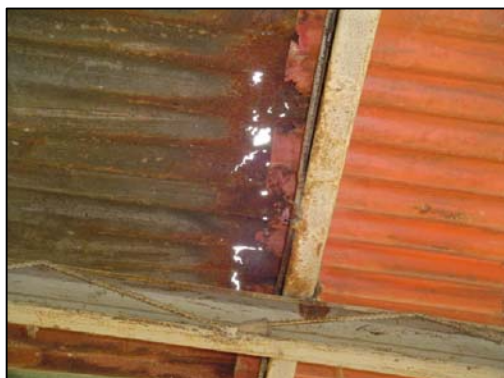
FOTOGRAFIA 4 Toda la estructura y techo de lámina cuenta con problema de oxidación, por lo que este debe de cambiarse en el modulo original de aulas.
