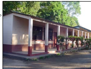
FOTOGRAFIA 4 cuenta con aulas planificadas en buen estado las láminas tienen a la oxidación, por lo que es necesario su mantenimiento
