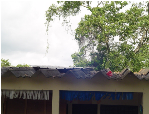
Fotografía No. 13: Falta de mantenimiento en techos
