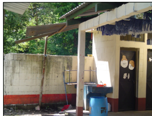
FOTOGRAFIA 5 pila de lavado, con techo provisional, no cuentan con drenajes fuera de el edificio.
