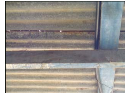
FOTOGRAFIA 2 Lámina de zinc oxidada y estructura de madera sin mantenimiento
