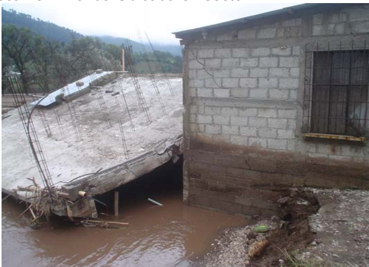
Foto 18 Vivienda Ubicada en sector D
