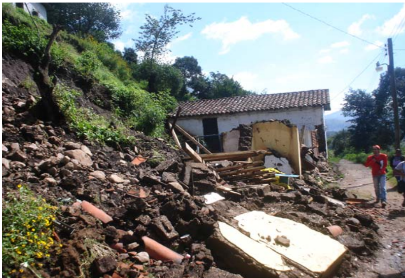
Foto 22 Deslizamiento de una vivienda ubicada sector A.
