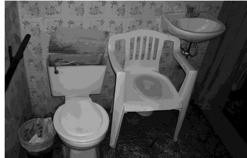
Fotografía 5. Servicio sanitario de hombres. Se evidencia el mal estado de los artefactos, además de no estar debidamente asegurados al muro (ver lavamanos). Ver Esquema 4. Fuente propia.
