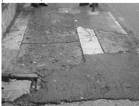
Foto No. 16 Aceras con superficie irregular y mezcla de materiales y colores. Toma: Ana C. Quiñónez J.
