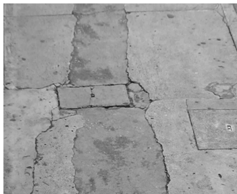
Foto No. 20 Las tapaderas de las acometidas domiciliarias lucen deterioradas. Toma: Ana C. Quiñónez J.
