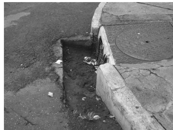
Foto No. 21 Además de que el asfalto ha superado el nivel de superficie de los tragantes, éstos se tapan debido a la basura que depositan en ellos. Toma: Ana C. Quiñónez J.
