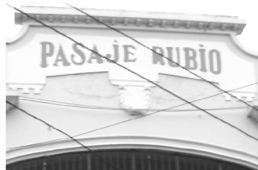
FOTOGRAFÍA No. 5 LA FACHADA DE LA NOVENA CALLE PRESENTA FISURAS Y DESPRENDIMIENTO DE ACABADOS
