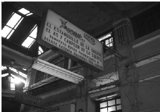
FOTOGRAFÍA No. 40 NÓTESE QUE LA PUBLICIDAD DE LOS COMERCIOS ES COLOCADA EN RÓTULOS QUE VAN ANCLADOS A LOS MUROS, ADEMÁS SE APRECIA QUE EL CABLEADO DE LAS INSTALACIONES ELÉCTRICAS DEL EDIFICIO ESTA EXPUESTO
