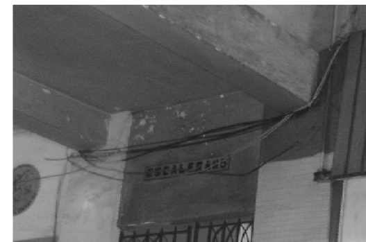
FOTOGRAFÍA No. 12 NÓTESE EL DESPRENDIMIENTO DE ACABADOS EN ESTA PARTE DEL MURO DE LA FACHADA
