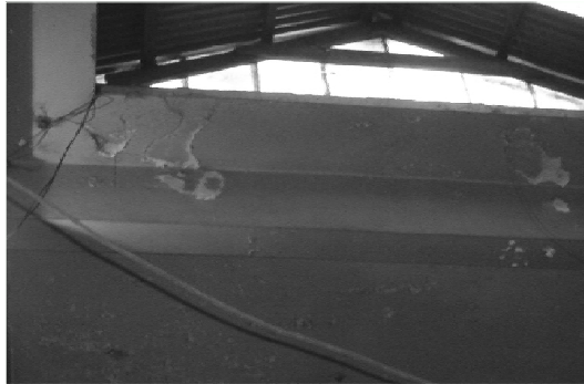
FOTOGRAFÍA No. 7 NÓTESE LAS FISURAS Y EL DESPRENDIMIENTO DE ACABADOS QUE PADECEN LAS VIGAS QUE SOPORTAN LA ESTRUCTURA DEL TECHO
