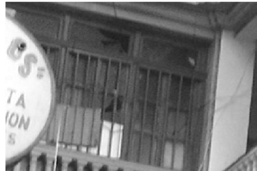
FOTOGRAFÍA No. 14 NÓTESE QUE LOS VIDRIOS DE ESTA VENTANA SE ENCUENTRAN ROTOS
