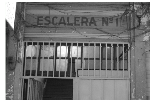
FOTOGRAFÍA No. 18 OBSÉRVESE EL DESPRENDIMIENTO DE ACABADOS EN LAS COLUMNAS QUE DELIMITAN LA PUERTA HACIA LAS ESCALERAS
