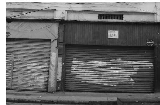
FOTOGRAFÍA No. 24 NÓTESE LA SUPERPOSICIÓN DE NUEVOS ACABADOS EN LA FACHADA
