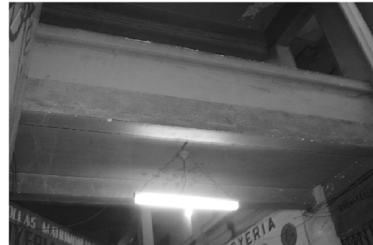
FOTOGRAFÍA No. 8 NÓTESE EL DESPORTILLAMIENTO DE LA VIGA Y PASAMADOS EN PUENTE Y MUROS DEL EDIFICIO
