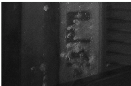
FOTOGRAFÍA No. 10 NÓTESE EL DESPRENDIMIENTO DE ACABADOS QUE PADECE LA COLUMNA
