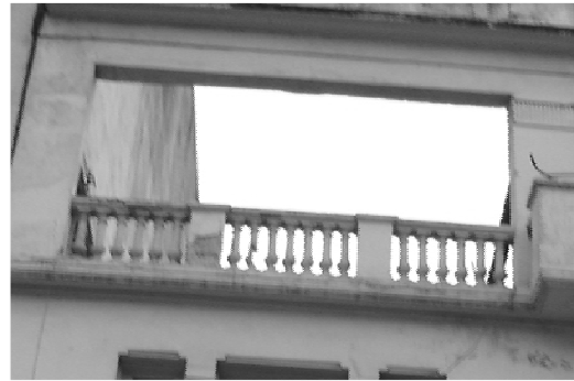
FOTOGRAFÍA No. 20 NÓTESE LA FALTA DE VENTANERÍA EN ESTE VANO
