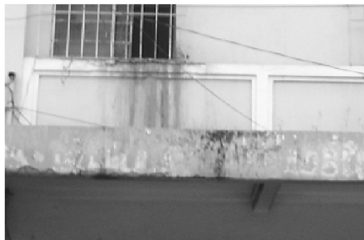
FOTOGRAFÍA No. 4 NÓTESE LA HUMEDAD EN EL MURO Y EL DESPRENDIMIENTO DE ACABADOS EN EL VOLADIZO DE LA FACHADA
