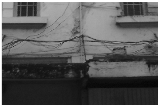
FOTOGRAFÍA No. 22 EL CABLEADO DE LAS INSTALACIONES ELÉCTRICAS ESTÁ EXPUESTO EN LA FACHADA
