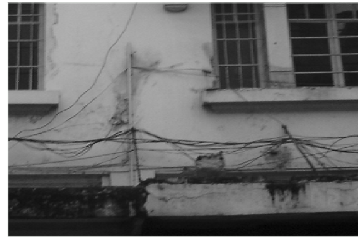
FOTOGRAFÍA No. 2 OBSÉRVESE EL DESPRENDIMIENTO DE ACABADOS Y LA HUMEDAD EXISTENTE EN LA FACHADA
