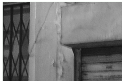
FOTOGRAFÍA No. 17 NÓTESE EL DESPRENDIMIENTO DE ACABADOS EN LA COLUMNA
