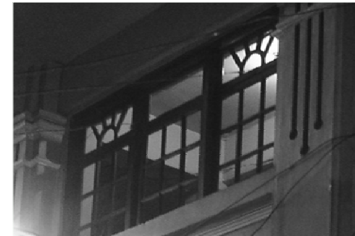
FOTOGRAFÍA No. 15 OBSÉRVESE QUE ESTA VENTANA CARECE TOTALMENTE DE VIDRIOS
