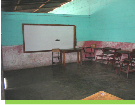
Foto # 2: Se observa el mal estado de de las instalaciones donde los alumnos reciben clases, el mal estado de la pintura y el piso son notorios en esta aula.
