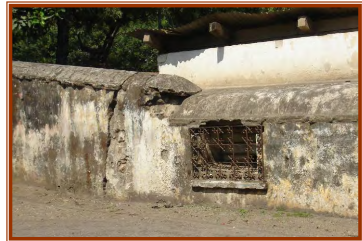
Finca San Nicolás, ventana y muro soterrado con arena de las inundaciones de los inviernos de cada año, parte antigua que aún de conserva original. Foto: DafneE
