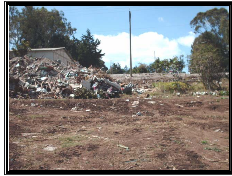
Demolición de edificaciones después de la toma de la Granja Penal Pavón
