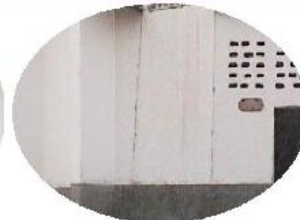
DETERIORO FÍSICO por grietas y fisuras
