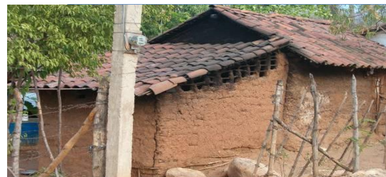
Fotografía 52. Vivienda vernácula, con muros de adobe y cubierta de teja Fuente: Elaboración propia
