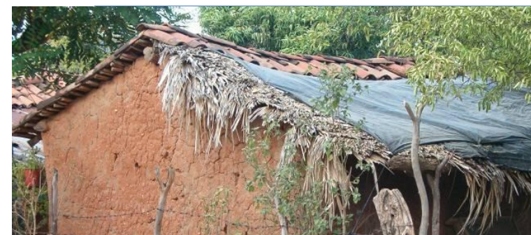
Fotografía 47. Lámina de zinc utilizada de manera improvisada en la cubierta Fuente: Elaboración propia
