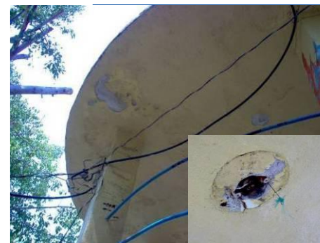
Fotografía 83. Cables expuestos, luminarias faltantes y arrancadas.
