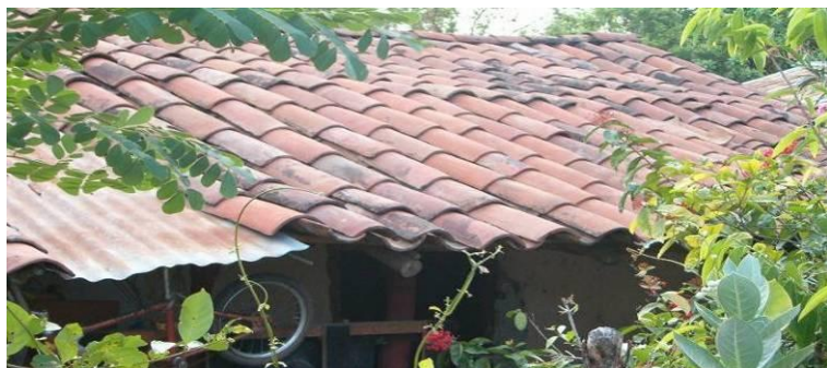
Fotografía 48. Lámina de zinc utilizada de manera improvisada en la cubierta Fuente: Elaboración propia
