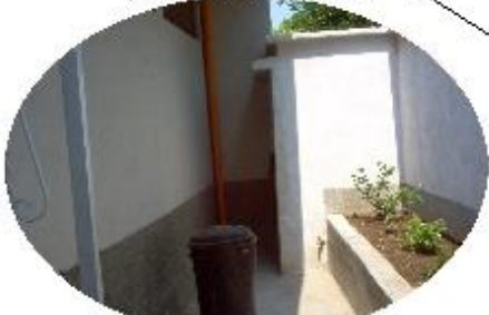
DETERIORO FÍSICO por falta de mantenimiento
