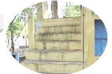
DETERIORO FÍSICO por decoloración de pintura
