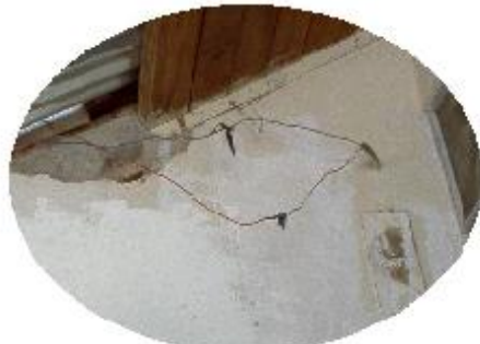
DETERIORO FÍSICO por decoloración de pintura
