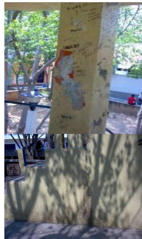
Fotografía 82. Paredes maltratadas, sucias, manchadas, destruidas y con espacios faltantes.
