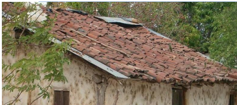
Fotografía 49. Lámina de zinc utilizada de manera improvisada en la cubierta Fuente: Elaboración propia
