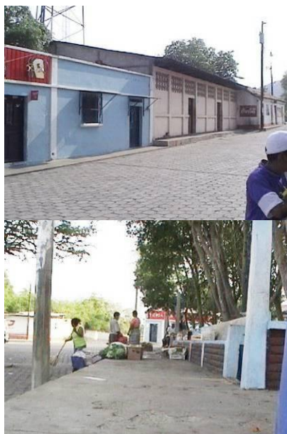
Fotografía 64. Aceras demasiado angostas y dañadas en contraste con las calles amplias.
