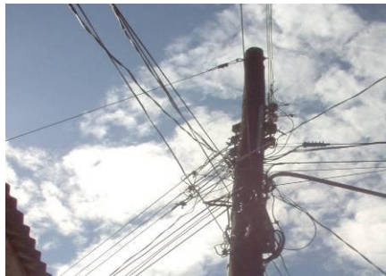
Fotografía 71. Postes de conducción eléctrica, se presenta el desorden y el grado de contaminación visual que causa al entorno.
