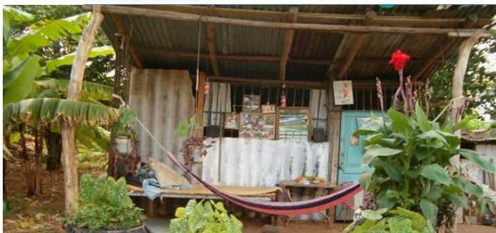
Fotografía 44. Vivienda en malas condiciones, con cerramiento de lámina de zinc Fuente: Elaboración propia
