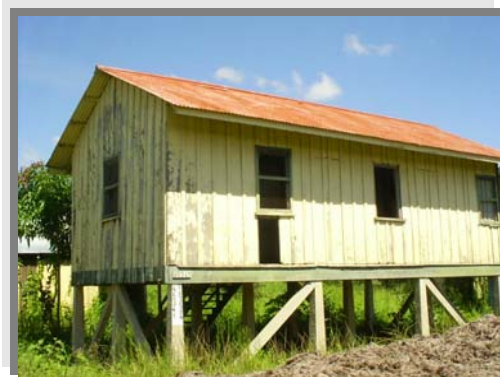
Fotografía No. 4.13 Vista exterior de una vivienda multifamiliar abandonada y en mal estado, en donde se puede observar la estructura y los pilotes.
