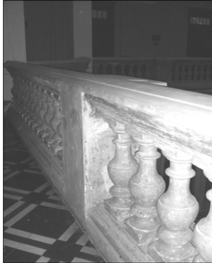
Fotografía 11. Desprendimiento de la pintura en pasamanos balastrado. Alteración Física.
