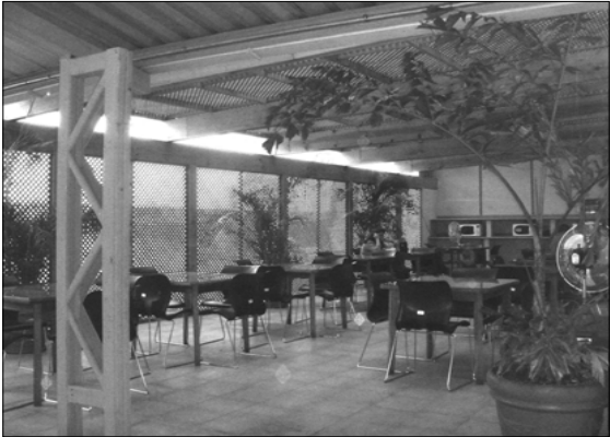
Fotografía 20. Superposición de piso, colocación de tabique, cubiertas e instalaciones en cafetería (azotea) Elementos agregados. Alteración Conceptual y Alteración Espacial.
