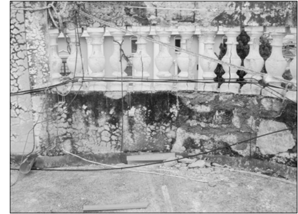
Fotografía 36. Presencia de humedad en parapeto. Alteración Física.
