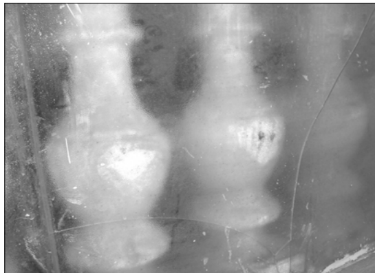
Fotografía 33. Colocación de plexiglás en balastradas de la terraza. Elementos agregados. Alteración Conceptual.
