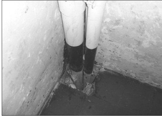
Fotografía 18. Tubería vista de la nueva instalación de drenajes. Elementos agregados. Alteración Conceptual.
