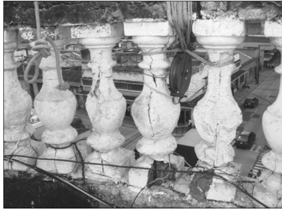
Fotografía 34. Grietas y desprendimiento de material en las balaustradas del parapeto. Alteración Física.
