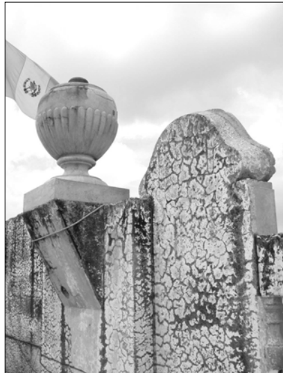
Fotografía 37. Presencia de humedad, Grietas y deterioro de material en elementos decorativos y parapeto. Alteración Física.
