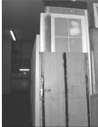
Fotografía 23. División de ambientes con tabiques de tablayeso. Elementos agregados. Alteración Conceptual Alteración Espacial.
