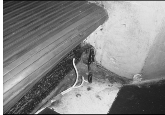
Fotografía 2. Cable visto de la nueva instalación eléctrica. Elementos agregados. Alteración Conceptual.
