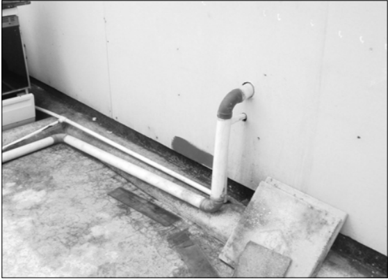
Fotografía 17. Tubería vista de la nueva instalación hidráulica y de drenajes. Elementos agregados. Alteración Conceptual.
