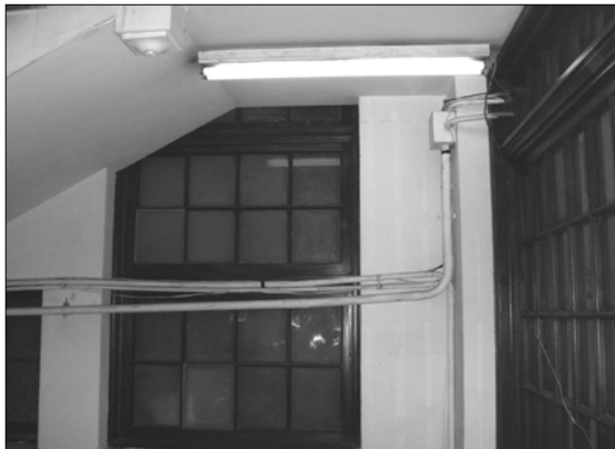
Fotografía 26. Tubería vista de la nueva instalación eléctrica. Elementos agregados. Alteración Conceptual.
