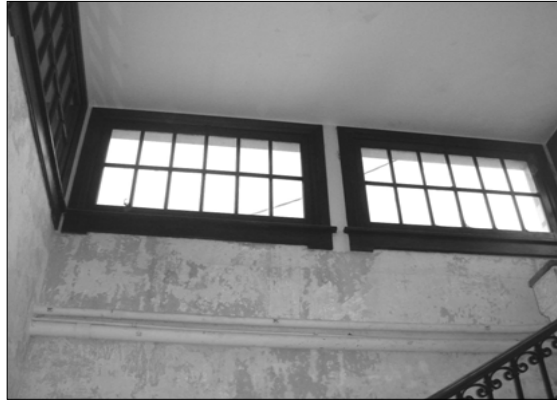
Fotografía 21. Desprendimiento de pintura en los muros de las gradas de servicio. Alteración Física.
