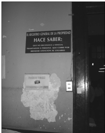
Fotografía 9. Desprendimiento de acabados. Alteración Física.
