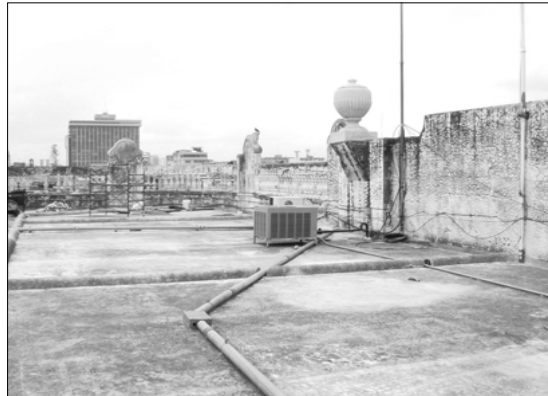
Fotografía 30. Presencia de humedad y Elementos vistos de las instalaciones nuevas. Elementos agregados. Alteración física y Alteración Conceptual.
