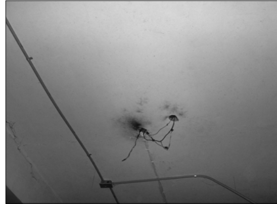
Fotografía 24. Tubería vista de la nueva instalación eléctrica. Elementos agregados. Alteración Conceptual.
