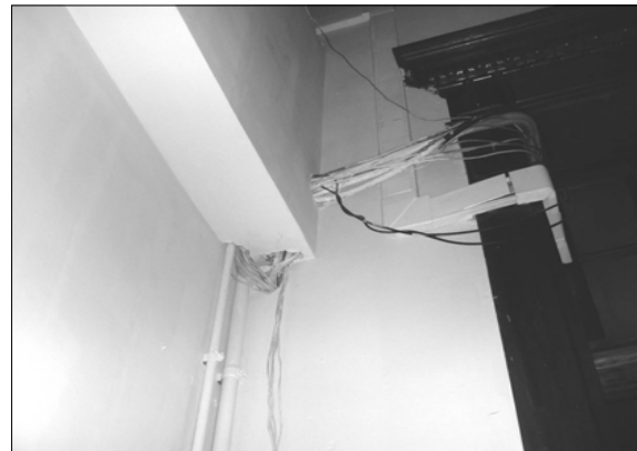
Fotografía 16. Cable visto de la nueva instalación eléctrica. Elementos agregados. Alteración Conceptual.
