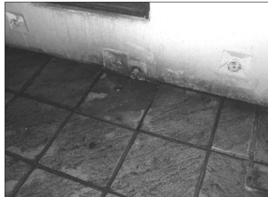
Fotografía 27. Superposición de piso (piso para exteriores) y presencia de humedad. Elementos agregados. Alteración Conceptual y Alteración Física.
