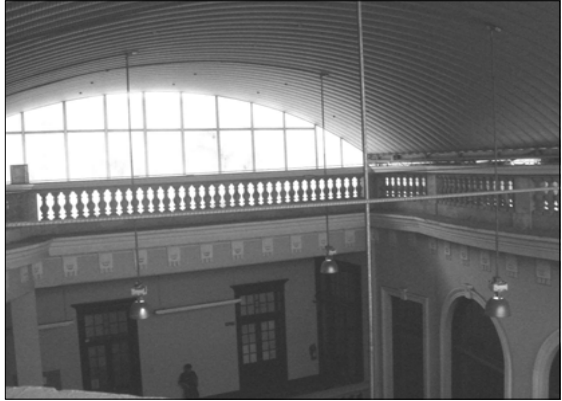
Fotografía 19. Instalación de lámparas halógenas sobre el patio central. Elementos agregados. Alteración Conceptual.
