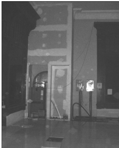
Fotografía 4. Instalación aire acondicionado. Elementos agregados. Alteración Conceptual.
