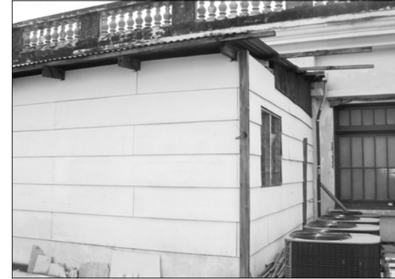
Fotografía 31. División de ambientes con tabiques de madera. Elementos agregados. Alteración Conceptual y Alteración Espacial.
