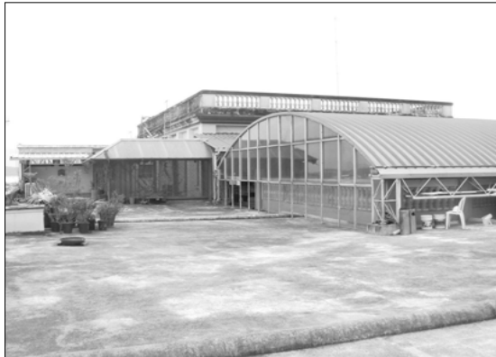
Fotografía 29. Colocación de cubiertas EMCO, lámina troquelada, lámina de zinc y lámina de fibrocemento. Elementos agregados. Alteración Conceptual.
