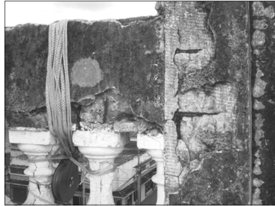
Fotografía 35. Desprendimiento y deterioro de material en repello. Alteración Física.
