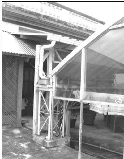
Fotografía 32. Colocación de base metálica para cubierta EMCO y presencia de humedad en losa. Elementos agregados. Alteración Conceptual y Alteración Física.
