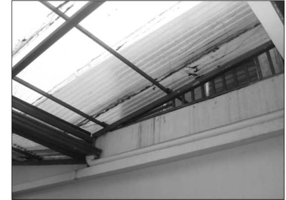
Fotografía 25. Colocación de cubierta de lámina de policarbonato transparente. Elementos agregados. Alteración Conceptual.
