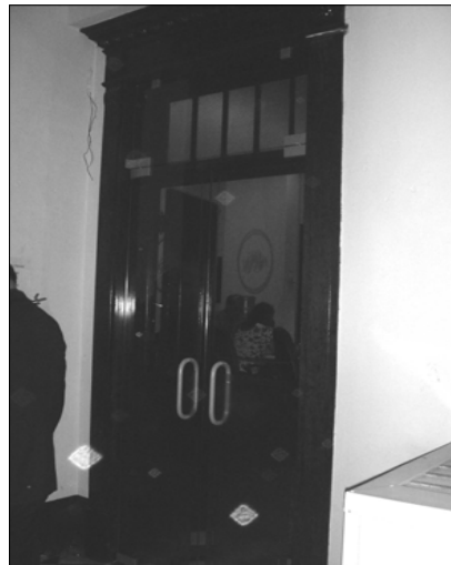
Fotografía 5. Puertas de vidrio templado en ingreso a oficinas. Elementos agregados. Alteración Conceptual.
