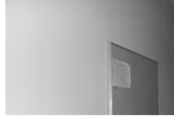
Fotografía 17: muros de Carga Registro de la Propiedad Fuente: fotografía tomada por el autor.
