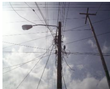
Fotografía No. 13 Poste de luz ubicado en la 30 Calle "A" y 2da Avenida de la Zona 8.
