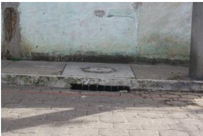
Fotografía No. 9. Ubicada en la 30 Calle “C” y 7ª. Avenida, Tragante con rejilla.
