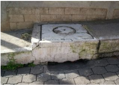
Fotografía No. 7. Vista de Tragante en la 30 Calle “C” en la 2da Avenida de la zona 8.
