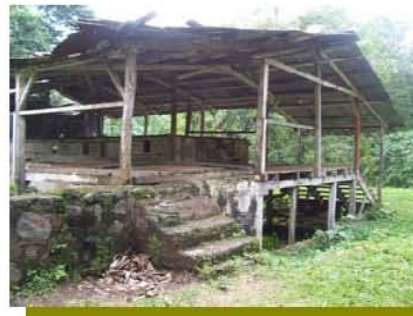
En estas fotos se puede ver la estación encuentros que aun cuenta con todo su sistema. Elaboración propia Foto
