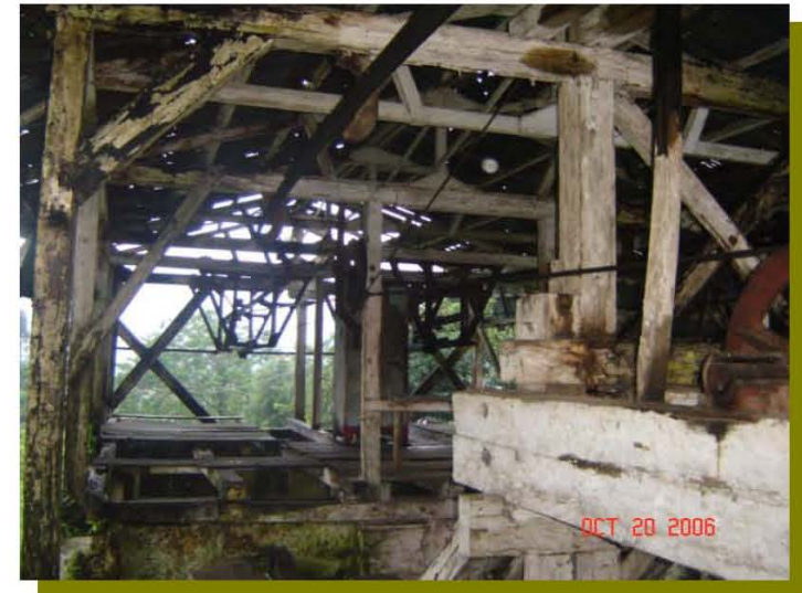
Foto 26 Vista del estado actual de la estructura del funicular Elaboración propia
