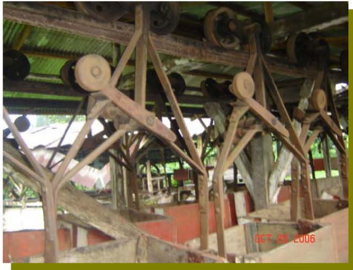
Foto 27 Se puede ver el estado actual de la estructura del funicular, Elaboración propia
