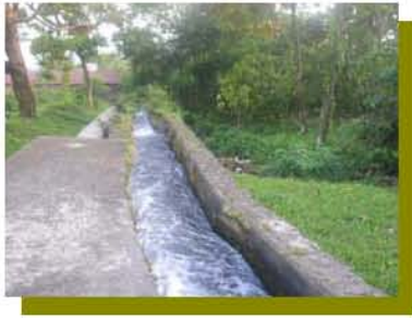
Aquí se ve la corriente que lleva el agua que va hacia la rueda que genera movimiento. Elaboración propia Foto
