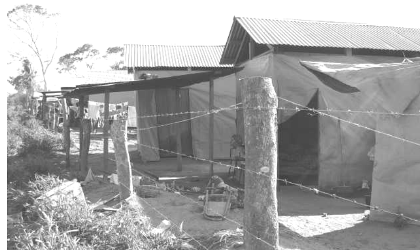
Fotografía 1.7 Deterioro actual de albergues
