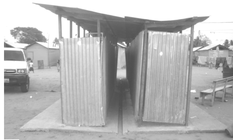
Fotografía 1.10 Deterioro de letrinas
