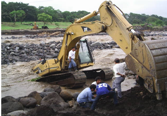
Foto No. 50 Pérdida en Infraestructura
