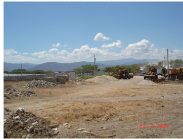
FOTO 10: OBSERVAMOS DESDE EL TERRENO HACIA LA GARITA DE INGRESO TAMBIEN SE OBSERVA LOS POSTES DE ENERGIA ELECTRICA
