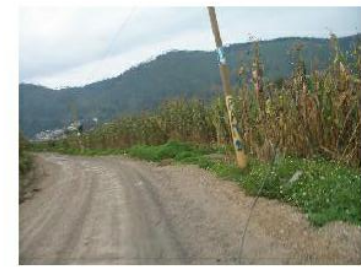
4.2.4.1 FOTO En esta foto se ven los postes de madera en los que se ubican los servicios de telefonía, electricidad y cable.
