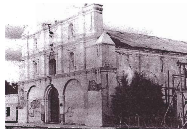
FOTOGRAFIA No. 21: VISTA EXTERIOR CON LOS DAÑOS DEL TERREMOTO DE 1,976. NÓTESE LA GRIETA AL CENTRO QUE PARTIÓ LA PORTADA EN DOS, Y LA ESPADAÑA QUE CAYÓ HACIA ATRÁS DESTRUYÓ PARTE DEL CORO ALTO DEL INGRESO Y LA CUBIERTA.
