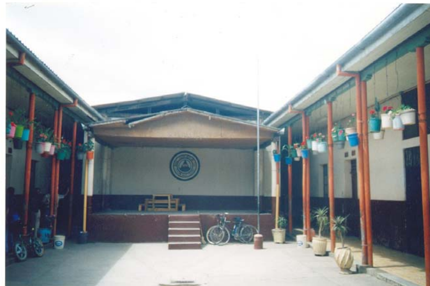
FOTOGRAFÍA No.44: VISTA INTERIOR ACTUAL, NOTESE LA PARED DEL AUDITORIO DESTRUIDA POR EL TERREMOTO DEL 76
