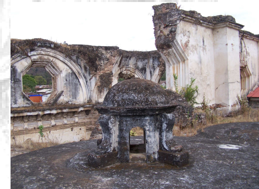
Fotografía No. 17 Vista de la cúpula de la Sacristía, aquí se puede observar el deterioro
