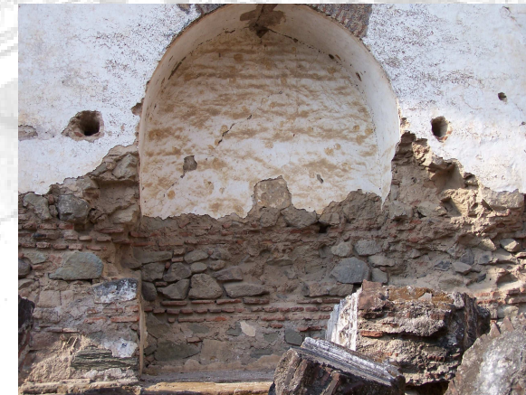
Fotografía No. 26 Aquí se observan los desprendimientos y deterioros de uno de los nichos de la nave del Templo.
