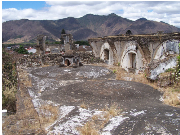
Fotografía No. 29 manchas, erosión y eflorescencia se aprecian en la parte exterior del techo de la sacristía.
