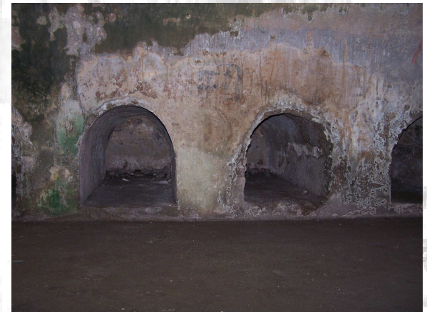
Fotografía No.36 Oxidación, sales, eflorescencia y se observa en las tumbas de la cripta de enterramiento.
