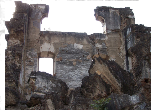
Fotografía No. 11 Vista del Coro Alto y Campanarios, aquí se puede observar el deterioro
