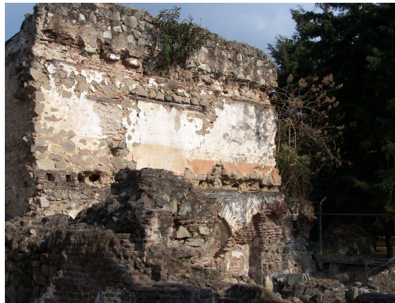
Fotografía No. 25 Aquí se aprecia la fachada de la sacristía la cual esta bastante deteriorada, tiene macroflora y microflora e insectos.
