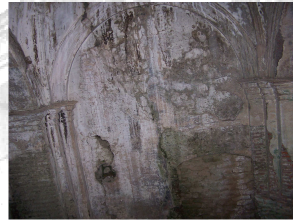
Fotografía No. 31 Manchas, fisuras, grietas, erosión, humedad y eflorescencia se aprecia en los muros interiores de la sacristía.
