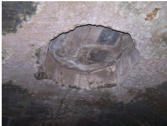
Fotografía No. 34 Humedad, eflorescencia, erosión, sales y humedad oxidación se aprecia en el ingreso a la cripta de enterramiento del Templo.
