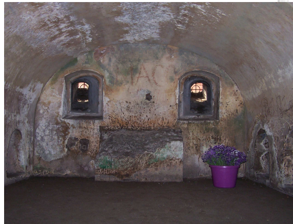
Fotografía No. 35 Humedad, eflorescencia, erosión, sales y oxidación se aprecia en la parte interna de la cripta de enterramiento.
