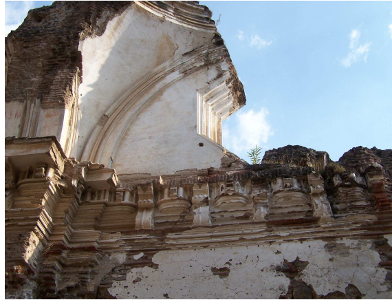
Fotografía No. 23 Pérdida de elementos que conformaban el vano de la ventana y el techo.
