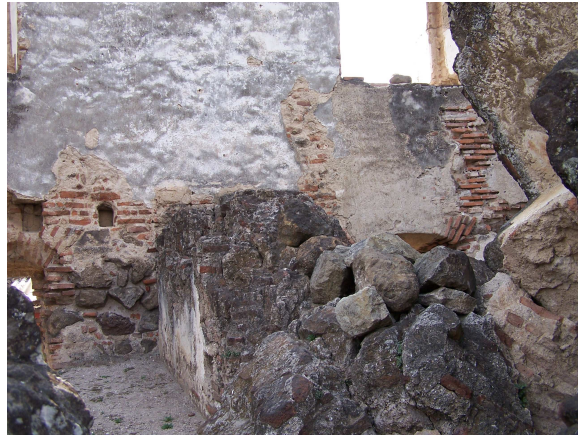
Fotografía No. 32 Aquí se aprecian los desplomes del techo del Templo.
