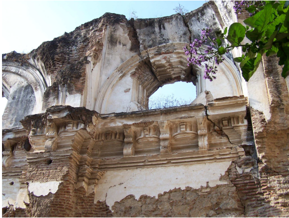
Fotografía No. 22 Grietas en los muros y eflorescencia
