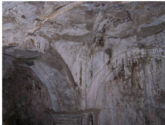
Fotografía No. 30 Manchas, fisuras, grietas, erosión, humedad y eflorescencia se aprecian en la parte interior del techo de la sacristía.
