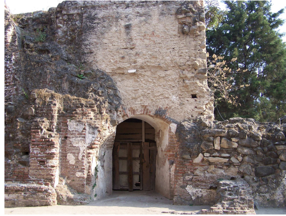
Fotografía No. 33 En el ingreso a la sacristía se observa erosión, desprendimientos, grietas, fisuras y eflorescencia.
