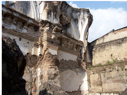
Fotografía No. 8 Estado de deterioro del Altar Mayor
