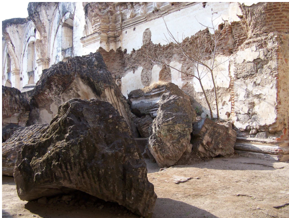
Fotografía No. 24 Aquí se puede observar los restos del techo los cuales se encuentran bastante deteriorados y también se observan árboles nacidos en la nave del Templo.
