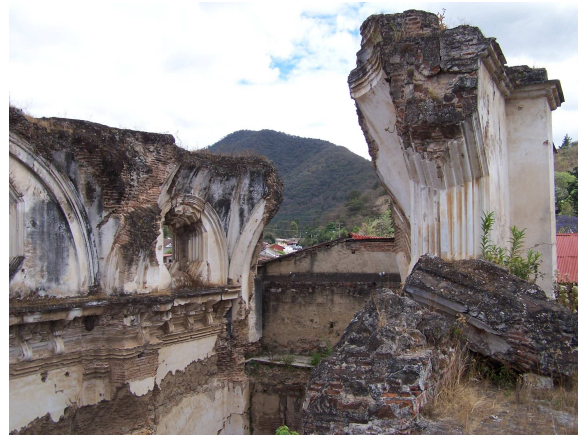
Fotografía No. 28 Desplomes, erosión, manchas, grietas y eflorescencia se observan en la parte alta de los muros de la nave del Templo.
