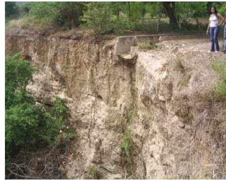
No. 4 Las laderas a orillas del río motagua generas en temporadas de invierno deslizamientos.
