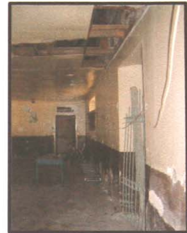
FOTO No.27 Techos interiores Ala Oeste Desprendimiento Antiguo Hospital Nacional de Huehuetenango
