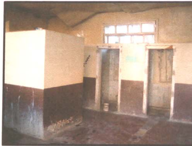
FOTO No. 41 Interior de servicios sanitarios Area afectada por humedad y hongos Antiguo Hospital Nacional de Huehuetenango
