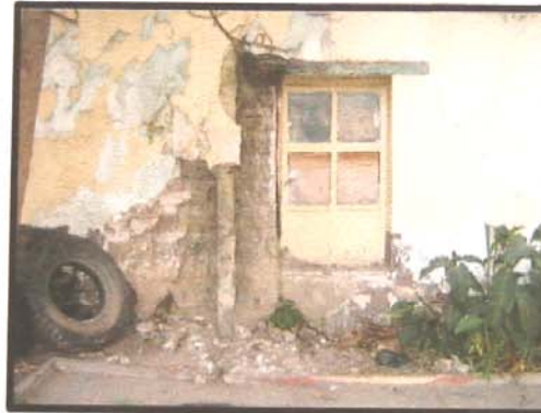
FOTO No.29 Muros interiores de patio central Desprendimiento Antiguo Hospital Nacional de Huehuetenango
