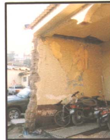
FOTO No. 33 Ala Oeste Colapso Muro por causas extrínsecas y desprendimiento de pintura Antiguo Hospital Nacional de Huehuetenango
