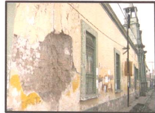
FOTO No.30 Fachada Principal Desprendimiento de Repello Antiguo Hospital Nacional de Huehuetenango
