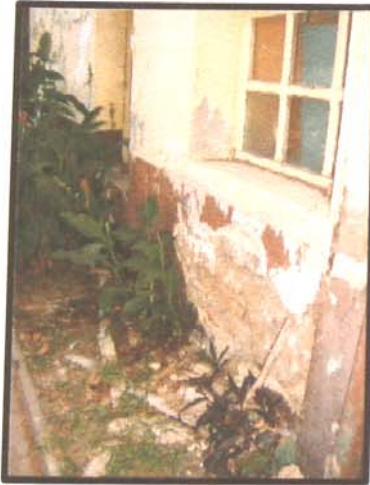
FOTO No. 40 Pintura de Muros Desprendimiento por causas físicas Antiguo Hospital Nacional de Huehuetenango
