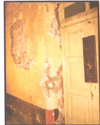
FOTO No. 42 Muros interiores Desprendimiento de pintura Antiguo Hospital Nacional de Huehuetenango
