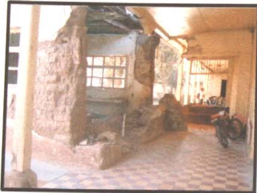
FOTO No.28 Muros interiores colapsados Afectada causas extrínsecas de acción temporal u ocasional Antiguo Hospital Nacional de Huehuetenango
