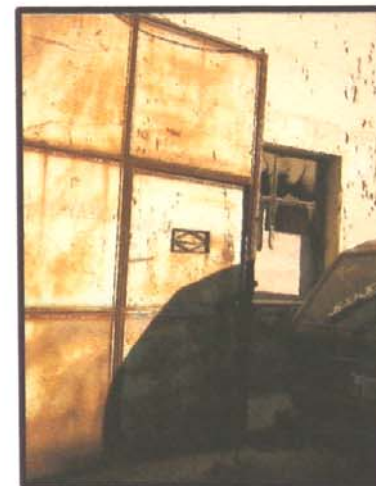
FOTO No. 36 Portones y ventanería exterior Afectadas por causas químicas por oxidación Antiguo Hospital Nacional de Huehuetenango
