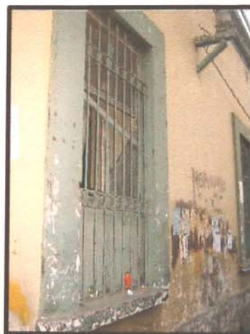
FOTO No. 35 Ventanas de Fachada principal Deterioro por causas físicas Antiguo Hospital Nacional de Huehuetenango
