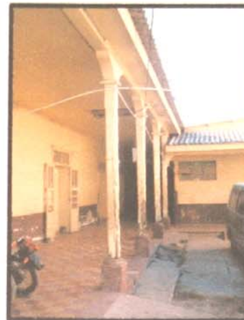
FOTO No. 20 Corredores Ala Oeste Area de Hombres Antigo Hospital Nacional de Huehuetenango
