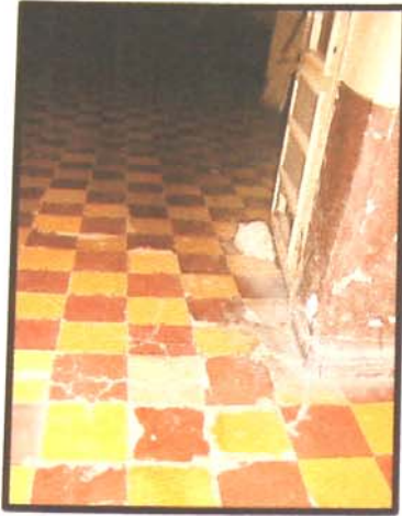
FOTO No. 37 Piso fracturado Afectado por causas extrínsecas Antiguo Hospital Nacional de Huehuetenango
