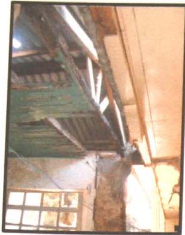
FOTO No.25 Estructura de cubierta Afectada por causas extrínsecas Antiguo Hospital Nacional de Huehuetenango
