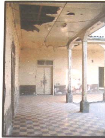
FOTO No.26 Techos interiores pasillos Afectados por causas extrínsecas Antiguo Hospital Nacional de Huehuetenango
