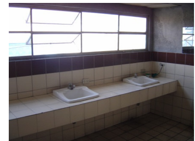
Vista No. 35 - Foto No. 99 Lavamanos dañados sin uso. (Elaboración propia, 2007)
