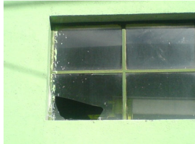
Vista No. 85 - Foto No.151 Ventanas rotas en varios lugares de la estación. (Elaboración propia, 2007)
