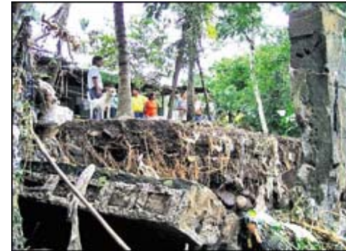
Foto No. 04. Deslizamiento en Cuyotenango Suchitepéquez, 2007. (Prensa Libre, martes 14 agosto. Lluvias causan daños, 2007. Recuperado el 02 de septiembre de 2007, de http://www.prensalibre.com/pl/2007/agosto/14/179658.html )
