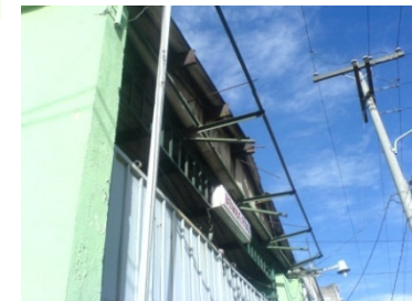
Vista No. 84 - Foto No. 150 Cubierta totalmente dañada nave principal completamente deteriorada. (Elaboración propia, 2007)
