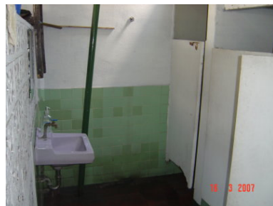
Vista No. 92 - Foto No. 157 Los baños actuales no se dan abasto para cubrir las necesidades de los bomberos de la estación. (Elaboración propia, 2007)
