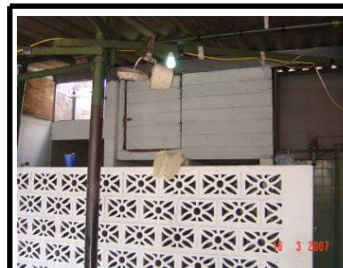
Vista No. 93 - Foto No. 158 Instalaciones eléctricas precarias. (Elaboración propia, 2007)
