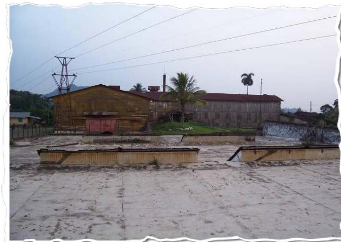
Foto # 3. Beneficio seco de café. Esta parte del conjunto está construido casi en su totalidad con madera y por el paso del tiempo y el descuido se encuentra muy deteriorado. Fotografía: W. de Paz y A. Pérez.
