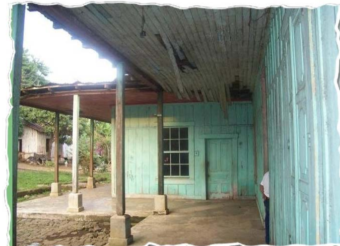
Foto # 8. Administración. Se puede observar el deterioro causado por la humedad en el edificio. Fotografía: W. de paz y A. Pérez.
