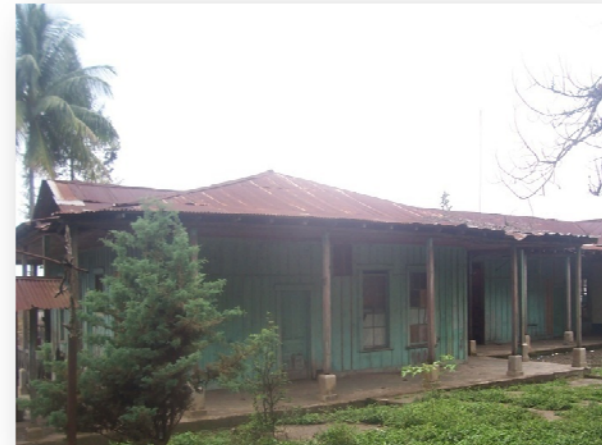
Foto #83. Oxidación y deterioro del techo de la Administración Fotografía: W. de Paz y A. Pérez
