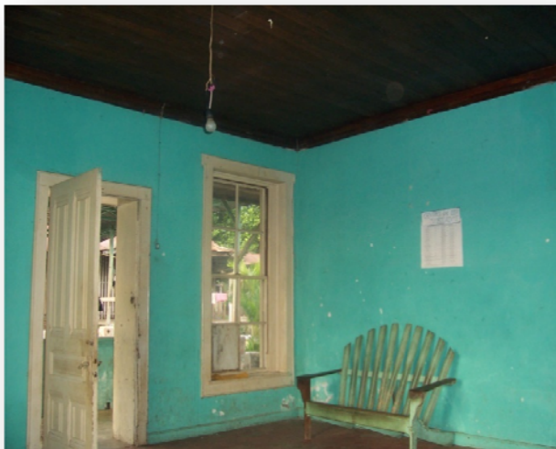
Foto #76. Deterioro de las puertas y ventanas de la Casa Patronal Fotografía: W. de Paz y A. Pérez
