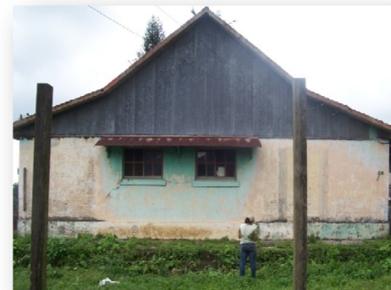
Foto #72. Deterioro de muros de la Casa Patronal Fotografía: W. de Paz y A. Pérez
