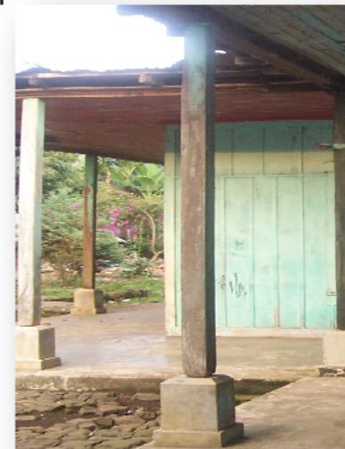
Foto #81. Las columnas de la Administración presentan daños severos. Fotografía: W. de Paz y A. Pérez
