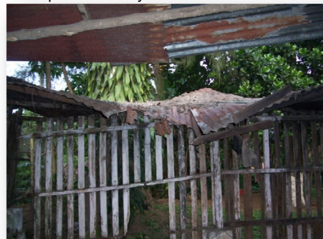
Foto #85. Deterioro de los muros de la cocina Fotografía: W. de Paz y A. Pérez
