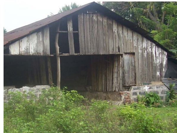
Foto # 92. Deterioro de muros de la caballeríza Fotografía: W. de Paz y A. Pérez
