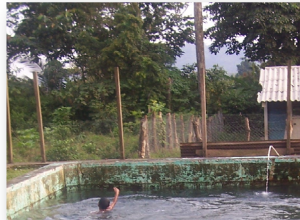
Foto #78. Deterioro de la piscina de la Casa Patronal Fotografía: W. de Paz y A. Pérez
