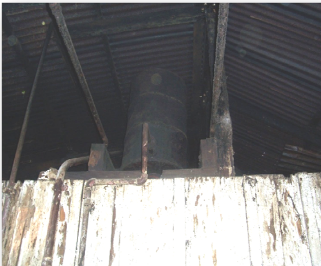
Foto #64. Instalación hidráulica y del contenedor de metal localizado en la ducha de la cocina Fotografía: W. de Paz y A. Pérez
