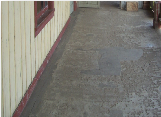
Foto #82. Deterioro de los pisos de cemento alisado de la Administración Fotografía: W. de Paz y A. Pérez
