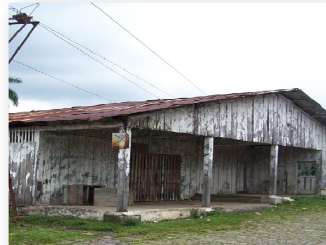
Foto #68. Columnas de la fachada frontal de la Bodega Fotografía: W. de Paz y A. Pérez
