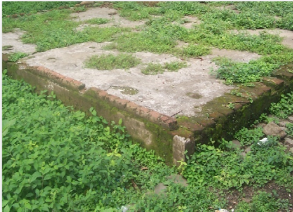
Foto #79. Deterioro que ha sufrido el cimiento de la Administración Fotografía: W. de Paz y A. Pérez
