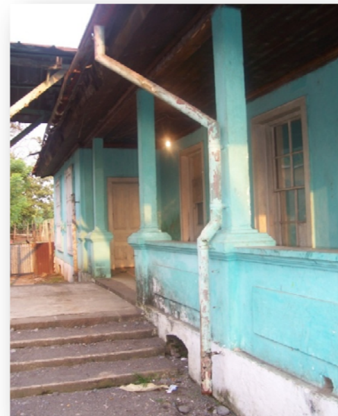
Foto #48. Bajada de agua de aluminio de la Casa Patronal. Fotografía: W.de Paz y A. Pérez
