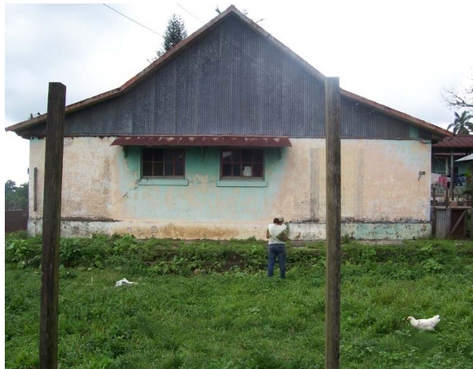
Foto # 10. Casa Patronal. Se observa la decoloración en las paredes por falta de mantenimiento. Fotografía: W. de Paz y A. Pérez.
