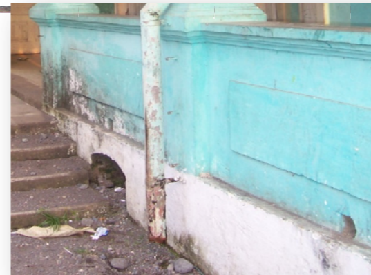
Foto # 71. Deterioro del cimiento de la Casa Patronal Fotografía: W de Paz y A. Pérez
