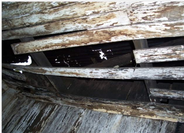
Foto #88. Deterioro del techo de la Cocina es producto de la oxidación de la lámina de zinc Fotografía: W. de Paz y A. Pérez
