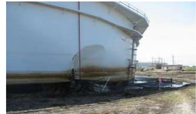
Fotografía No. 13, Daños severos en pared de tanque, Refinería Meraux, Nov. 2005. Fuente: fotografía EPA. Huracán Katrina.
