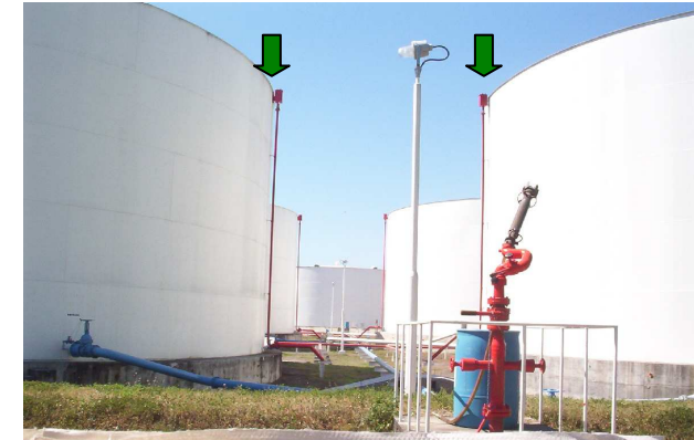
Fotografía No. 25, al frente cañón lanza agua y espuma, al fondo en la parte superior de los tanques las cámaras de espuma. Fuente: Datos Terminal / Foto propia
