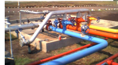
Manifold principal en Terminal de almacenamiento
