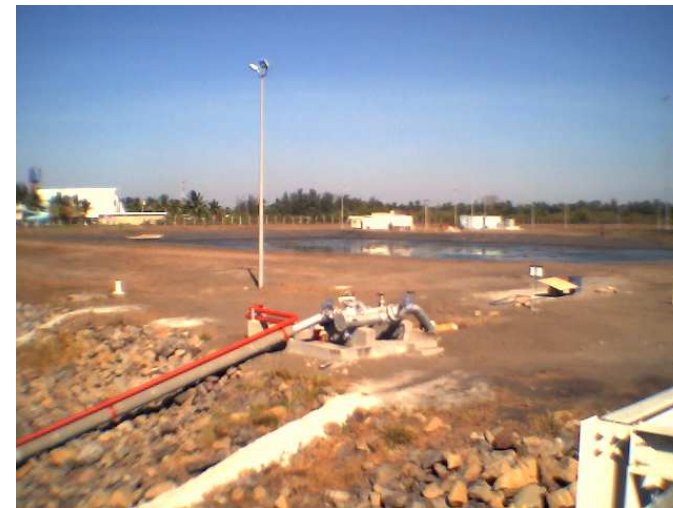
Fotografía No. 18, área de manifold y válvulas controladoras. Fuente: Propia
