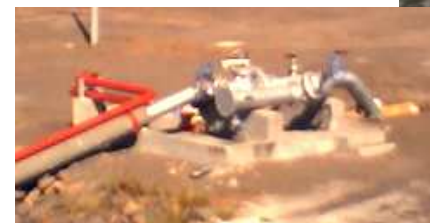
Manifold de válvulas en terminal de recepción
