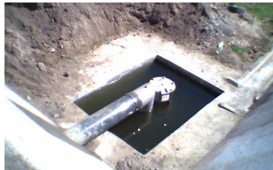
Fotografía No. 27 válvula densométrica, instalada en los drenajes de los diques de contención
