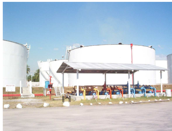
Fotografía No.21 Muestra Módulo de equipos para impulsar productos Fuente: información Terminal. / Fotografía propia.
