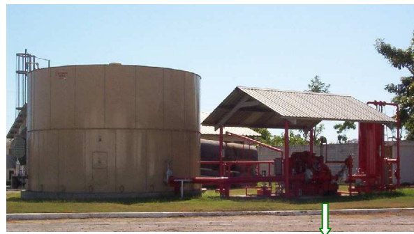
Fotografía No. 23 Modulo contra incendios, Tanque de 80,000 galones y sistema contra incendios, a la derecha en rojo tanque de vejiga Fuente: Terminal / Foto Propia.
