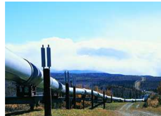
Fotografía No.7, Oleoducto superficial en su fase de operación. Fuente: Pagina de Internet, Oleoducto en Norte América.
