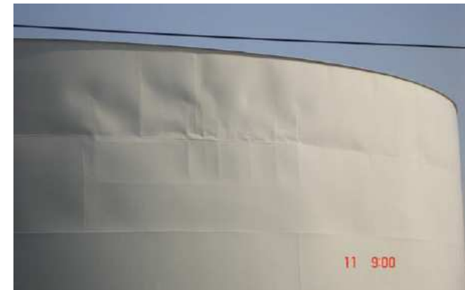
Fotografía No. 11, Port Arthut, Texas octubre./ deflexiones en paredes de tanque Fuente: Luis A. Godoy, Universidad de Puerto Rico, misión de reconocimiento. Huracán Rita.
