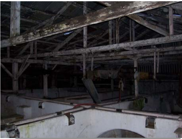
Foto #60. Vista del deterioro en las columnas del Beneficio húmedo Fotografía: W. de Paz y A. Pérez
