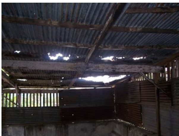
Foto #69. Cubierta deteriorada por agentes climáticos del Beneficio seco Fotografía: W. de Paz y A. Pérez
