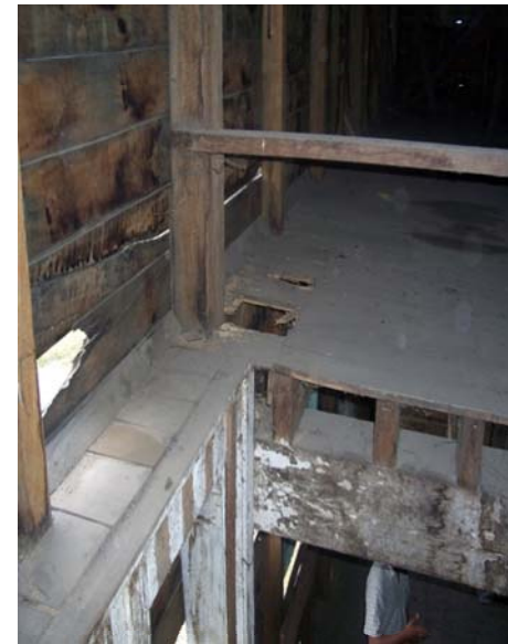
Foto #68. Entrepiso deteriorado del Beneficio seco Fotografía: W. de Paz y A. Pérez
