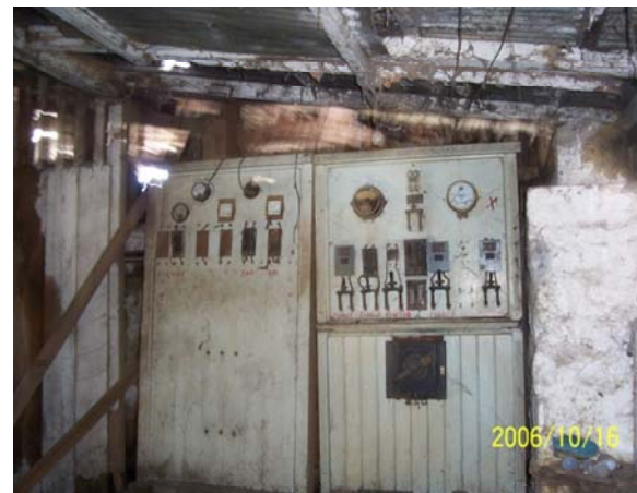
Foto #63. Generador de energía eléctrica del Beneficio húmedo Fotografía: W. de Paz y A. Pérez
