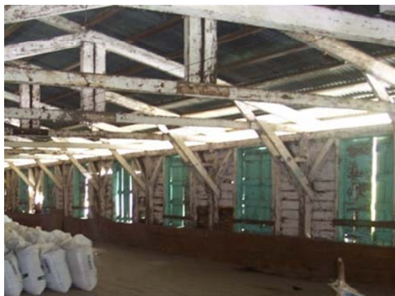
Foto #55. Ventanas de madera beneficio seco. Fotografía: W. de Paz y A. Pérez
