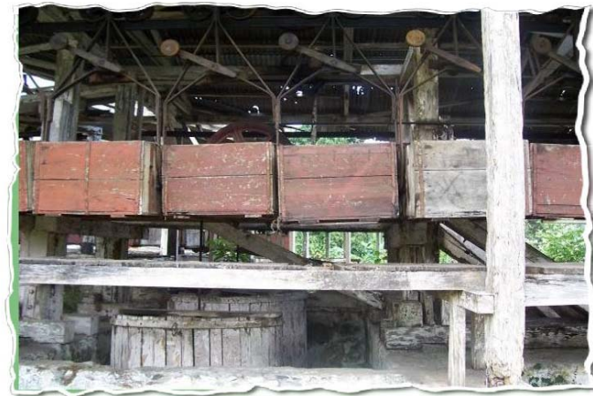
Foto # 7. Teleférico. Se pueden observar los vagones del teleférico en donde se transportaba el café. En el año 2000 se dejó de utilizar a causa del deterioro. Fotografía: W. de Paz y A. Pérez.
