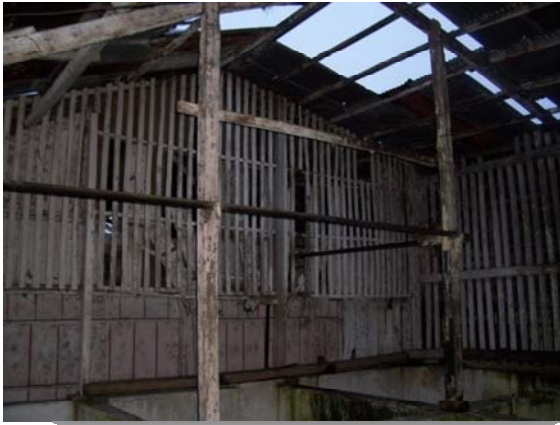
Foto #59. Muros con fuerte deterioro del Beneficio húmedo Fotografía: W. de Paz y A. Pérez
