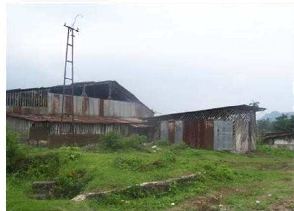
Foto #42. Vista posterior de la herrería. Por causa del deterioro en la madera se ha ubicado lámina en algunas áreas de beneficio húmedo Fotografía: W. de Paz y A. Pérez
