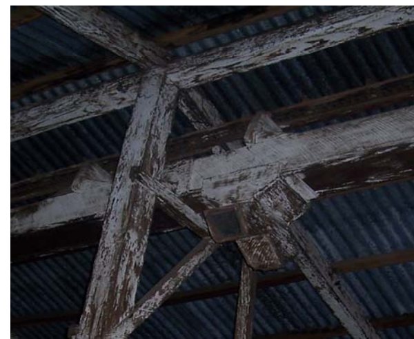
Foto #74. Deterioro del elevador del Beneficio seco es fuerte debido a esto hay muchas áreas donde no funciona Fotografía: W. de Paz y A. Pérez
