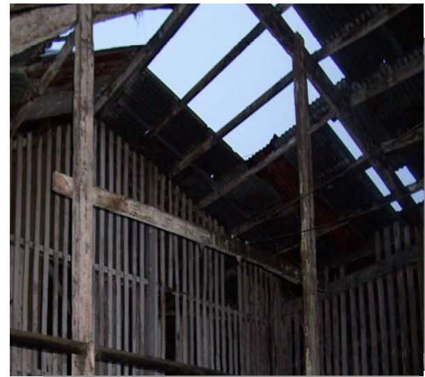
Foto #61. Deterioro en el techo del beneficio húmedo . Fotografía: W. de Paz y A. Pérez
