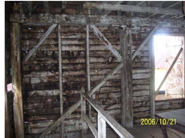
Foto #65. Muros de madera deteriorados del Beneficio seco Fotografía: W. de Paz y A. Pérez
