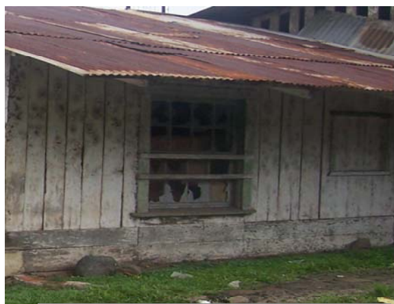
Foto #62. Ventanas del beneficio húmedo las cuales se encuentran con daños. Fotografía: W. de Paz y A. Pérez
