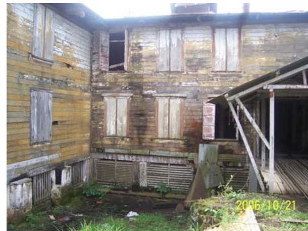
Foto #70. Puertas y ventanas con fuerte deterioro del Beneficio seco Fotografía: W. de Paz y A. Pérez
