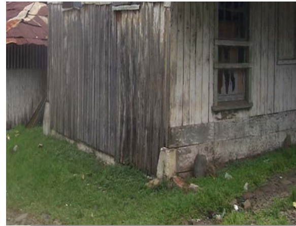
Foto #58. Cimiento con fuerte deterioro del beneficio húmedo.
