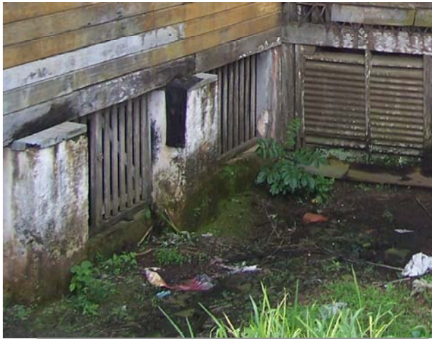
Foto #64. Deterioro del cimiento del Beneficio seco Fotografía: W. de Paz y A. Pérez
