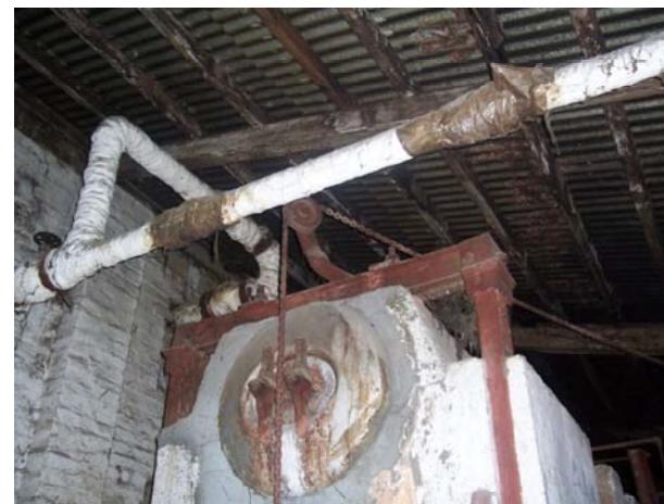
Foto #71. Instalaciones se encuentran recubiertas con yeso para evitar que siga avanzando el deterioro. Fotografía: W. de Paz y A. Pérez
