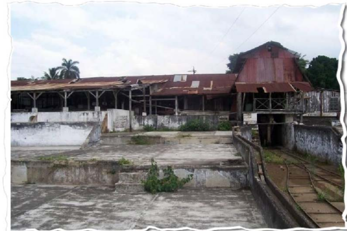
Foto #2. Beneficio húmedo de café. Esta parte del beneficio en la actualidad es utilizada en época de cosecha, pero el deterioro es inminente. Fotografía: W. de Paz y A. Pérez.
