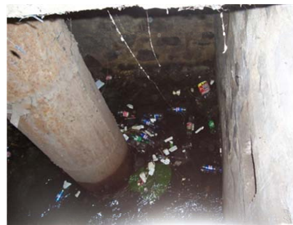
Foto #57. Tubería que conduce el agua hacia el beneficio seco. Fotografía: W. de Paz y A. Pérez
