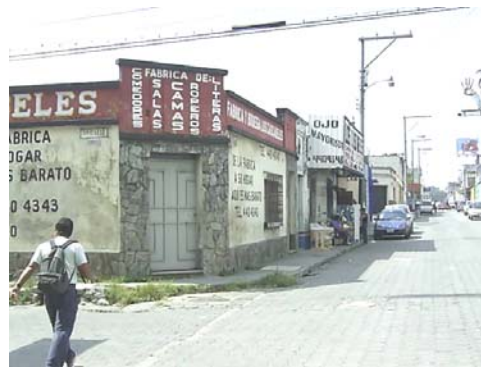
Deterioro en viviendas
