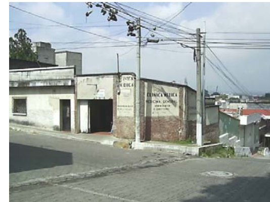
Instalaciones Eléctricas y telefónicas en mal estado
