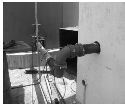
Válvula de cierre (compuerta) tipo vástago saliente en la tubería de aspiración
