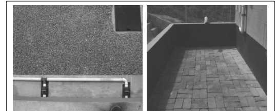
Salida reactor UASB hacia patio de secado
