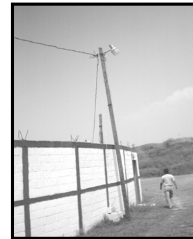
Fotografía 11: La infraestructura está en mal estado. El cableado está tendido sobre el graderío.
