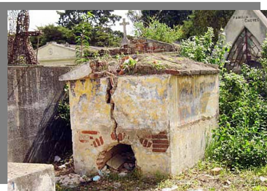
Foto No 45 Fuente: Prensa Libre Nichos en mal estado
