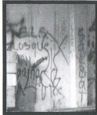
FOTO 1.4 F2 MURO DE MERCADO
