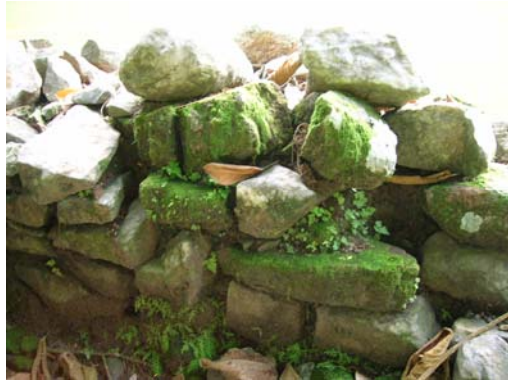
Fotografía 4. Desprendimiento pétreo, humedad y crecimiento de flora.
