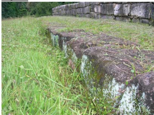
Vista de la degradación del material pétreo de una grada, donde se ha intervenido para unirlos con mortero con cemento.
