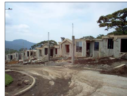
* COMO OBSERVAMOS EN LA SIGUIENTE FOTO VEMOS QUE LAS CASAS SON EN SERIE, EN ESTE SECTOR TODAVIA NO HAN SIDO TERMINADAS, Y TODAVIA SE ENCUENTRA EN OBRA GRIS.
