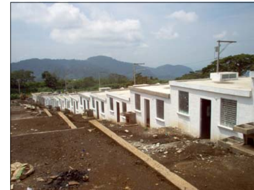
* VIVIENDAS EN SERIE EN ÉSTA ÁREA TODAVÍA NO LA HAN CULMINADO, FALTA REACOMODAR LA JARDINIZACION Y A LA VEZ APLICARLE UNA MANO DE PINTURA A LA CASA ASI MISMO HACER LAS DIVISIONES ENTRE CADA UNA DE LAS VIVIENDAS.
