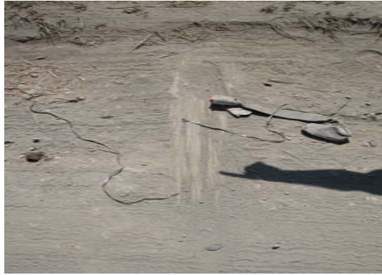
Ilustración 4.3. TRAMO FERROVIARIO DE AMATITLÁN-PALÍN MILLA 224 Fuente: Fotografía propia tomada en visita de campo.
