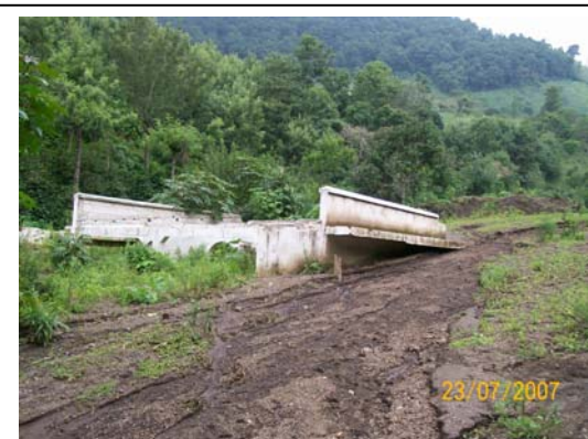
Foto No.7: Deslizamiento ocurrido en 2005 en la Aldea Pajales 2. Acatenango, Chimaltenango
