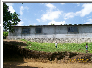
Foto No.2: Se puede apreciar el cambio de nivel que existe en el patio del predio.
