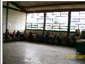
Foto No.4 Vista de un aula del módulo 4, el piso es de granito y la cubierta de techo de fibrocemento
