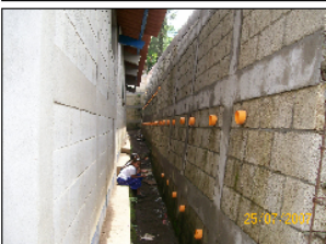
Foto No. 3: Vista de uno de los muros de contención dentro del predio, se puede ver el tratamiento para drenar el agua a través del muro, sin embargo no existe un tratamiento en el suelo.
