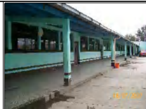
Foto No.2: El edificio 3 dentro del predio tiene un ambiente de cocina, es estado general del edificio es bueno.
