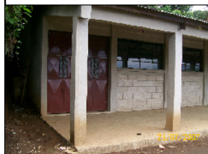
Foto No. 1: Vista del ingreso al edificio, se ve una puerta doble de metal, al lado izquierdo existe un corte de terreno, el cual tiene un muro de contención, por lo que puede generar el riesgo de derrumbe.
