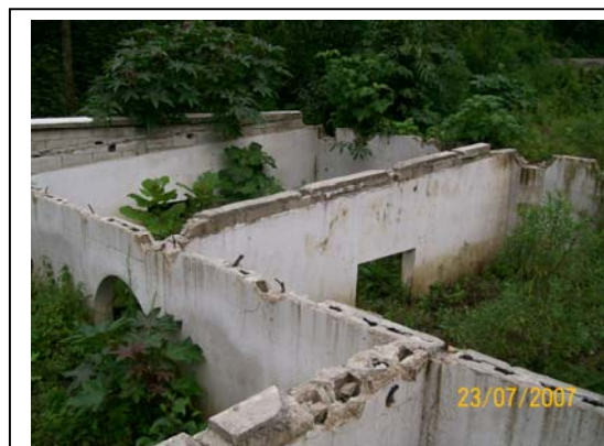
Foto No.8: Deslizamiento ocurrido en 2005 en la Aldea Pajales 2, Acatenango, Chimaltenango
