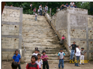
Foto No. 7: Vista del módulo de gradas en el ingreso al predio, la diferencia con el nivel superior es de casi 4.00 mts, al muro de contención tiene tratamiento de drenaje sin embargo no existe un canal a nivel del suelo para conducir el agua.
