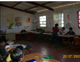
Foto No.2: Vista de una de la aulas, se puede observar que el piso es de cemento líquido, el deterioro es más notorio en cuanto a la fecha de ejecución.
