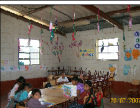
Foto No.3: Vista de otra aula en el edificio 2, se pueden observar manchas en estales para evitar la filtración de agua, esto debido al deterioro de la lámina de fibrocemento.
