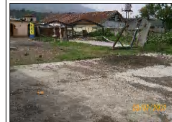
Foto No. 2: Vista del predio, el módulo de baños está inservible, existía una construcción que con el tiempo se destruyó.
