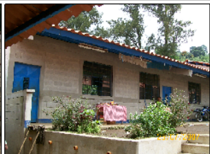
Foto No. 6: El otro módulo de baños tiene las mismas características constructivas, se puede ver el tratamiento de drenaje en el muro, sin embargo tampoco tiene un tratamiento en suelo para drenar el agua de lluvia.
