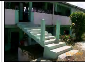
Foto No. 4: Vista de los diferentes niveles del edificio, falta la baranda en las gradadas que van al segundo nivel.
