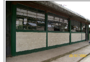
Foto No.2 Vista del módulo 2, el cual consta de dos aulas, su característica principal es la de tener una división interior movable, lo que permite convertir el módulo en un sólo ambiente.
