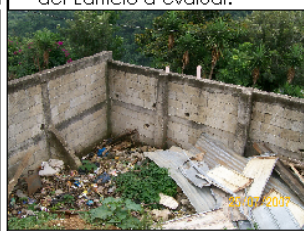
Foto No. 1: Vista del muro perimetral del predio, se puede observar el tipo y materiales que se han utilizado en el predio por trabajos de remodelación.
