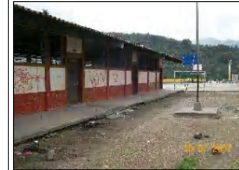
Foto No. 3: Vista de la fachada hacia el interior del predio, el patio es de tierra, la topografía es plana, presenta deterioro en ventanas y techo.
