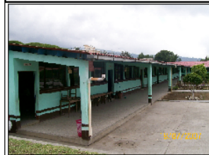
Foto No.1: El predio del edificio 041103 tiene 5 edificios de los cuales tres de ellos tienen características similares, este es el edificio 2, el cual se encuentra en buen estado.
