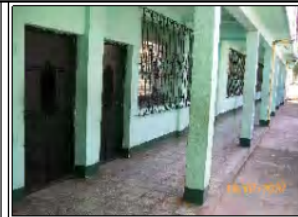
Foto No. 2: Vista del corredor en el primer nivel, se observa que no existe una cuneta o drenaje de aguas pluviales.
