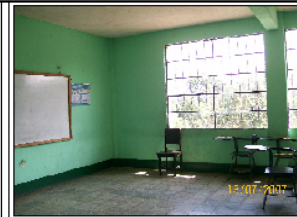
Foto No. 3: Todas las aulas tienen buena iluminación y ventilación, además en entrepiso es de concreto en buen estado.
