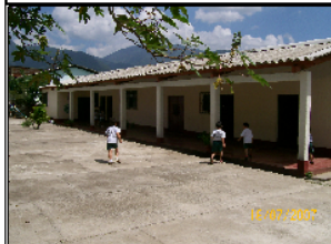
Foto No.1: El estado general del edificio es bueno, tiene un patio cementado en un lado del predio.
