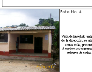
Foto No. 4: Vista del módulo antiguo de la dirección, se utiliza como sala, presenta deterioro en ventanas y cubierta de techo.
