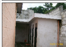
Descripción: Vista de la batería de baños de hombres, los cuales son independientes, el depósito de agua provee el vital líquido por gravedad a los inodoros.
